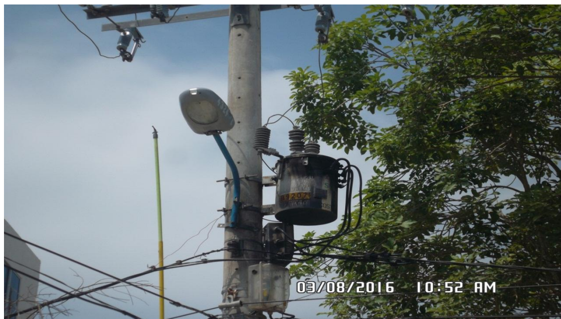
Imagen 19. Transformador quemado por sobrecarga. (Fuente: foto del autor).
