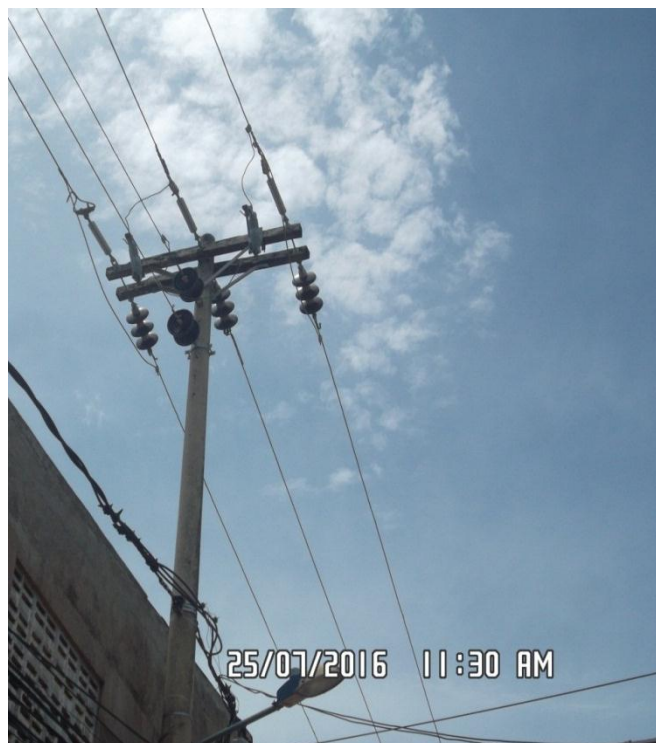
Imagen 16. Fusibles de expulsión puenteados (fuente: foto del autor).
