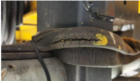
Ilustración 28. Aislante de cableado agrietado
