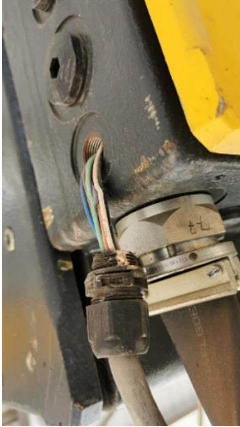
Ilustración 25. Cableado sin aislamiento
