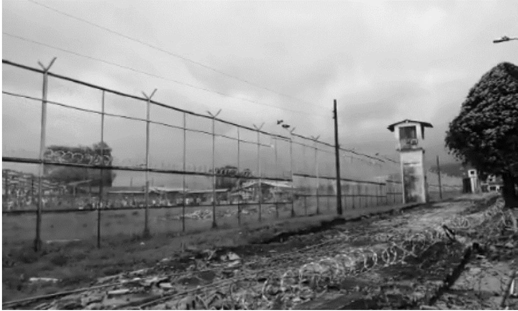
Ilustración 41 Desplome del muro exterior del centro penitenciario
