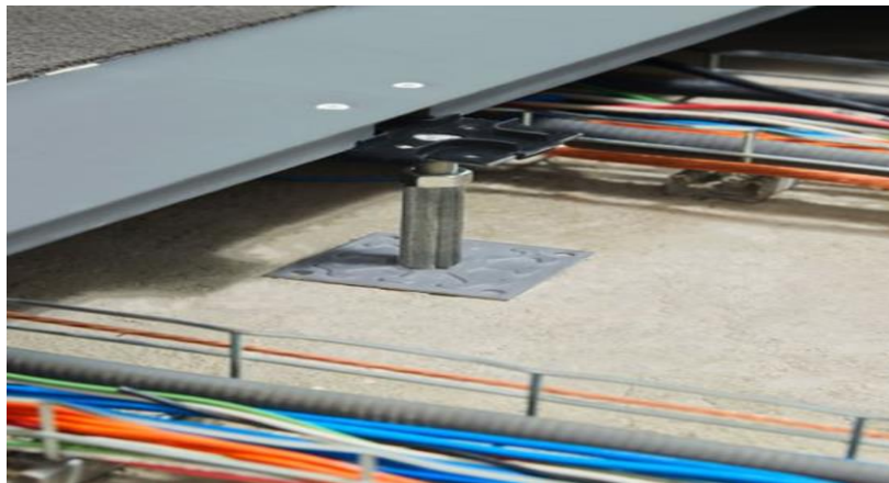
Ilustración 36: Cableado en piso falso Fuente: Hunter Douglas Colombia S.A.S (2021)
