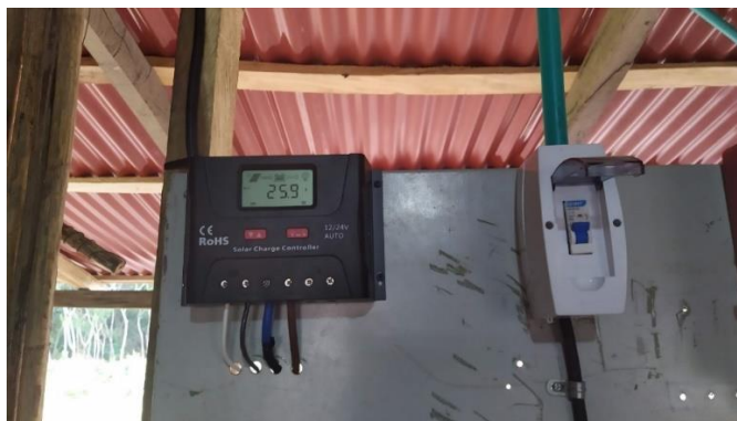
Fig. 64 Controlador solar con la carga de los paneles solares en buen funcionamiento. (Autor)
