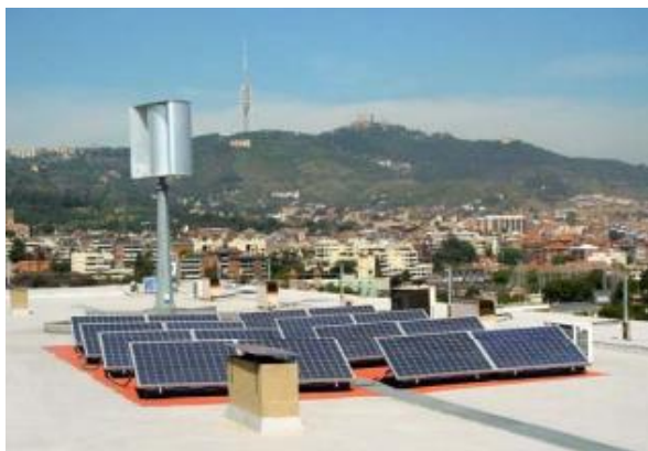
Fig. 22 Vista de la instalación híbrida SAGER en el tejado de la ETSEIB, en Barcelona. [20]
