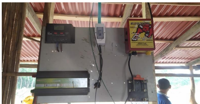
Fig. 49 Posicionamiento del panel de mando con sus accesorios eléctricos. (Autor)
