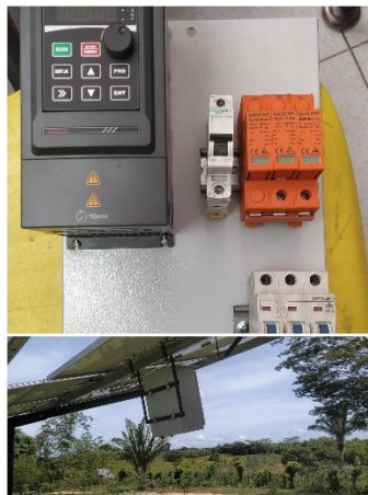
Fig. 114 Posicionamiento del panel de mando con sus accesorios eléctricos. (Autor)
