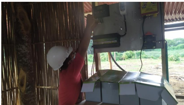
Fig. 60 Conexión de los componentes del panel demanda con los paneles solares. (Autor)
