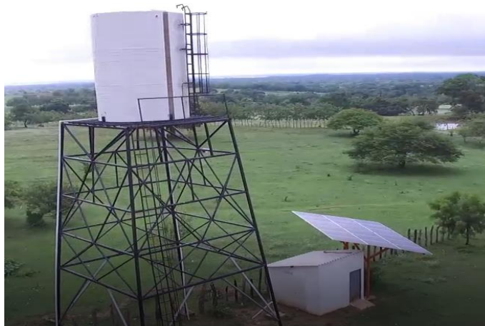
Fig. 26 Sistema Fotovoltaico Para Acueducto Rural. (Autor)
