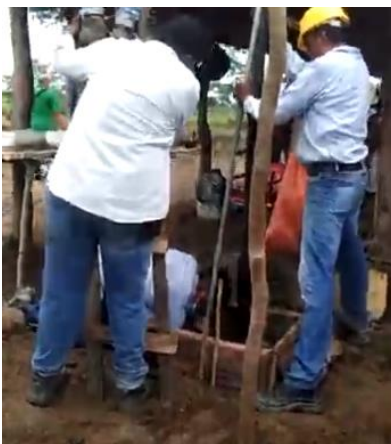
Fig. 57 Vaciado de concreto en la cavidad de incrustación de la estructura. (Autor)
