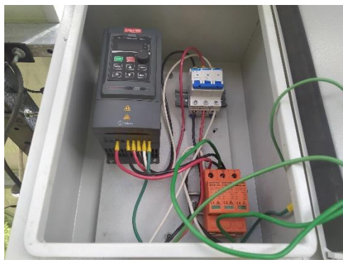
Fig. 118 Conexión de los componentes del panel demanda con los paneles solares. (Autor)
