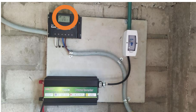
Fig. 93 verificación de la energía producida por los paneles hacia el controlador de carga solar.
