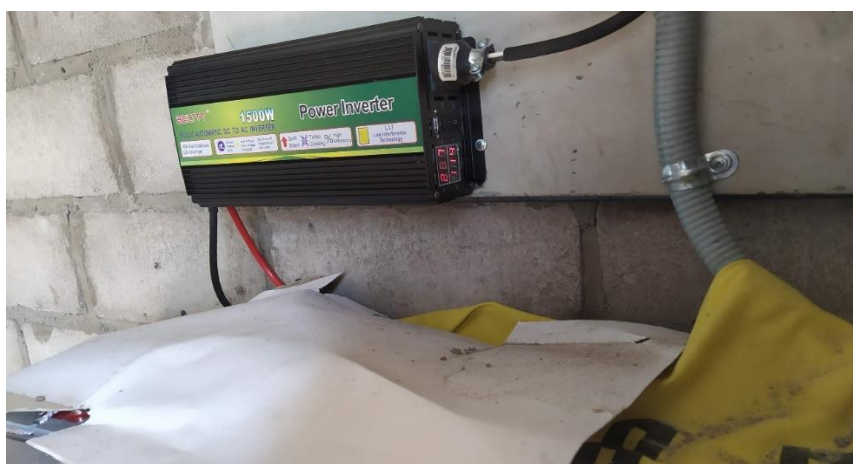
Fig. 94 voltaje de salida correcto por parte del inversor. (Autor)
