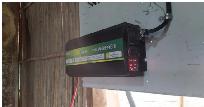
Fig. 65 Inversor en buen funcionamiento, arrojando 117 VAC. (Autor)
