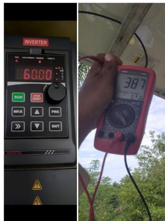
Fig. 121 Medición del voltaje al variador. (Autor)
