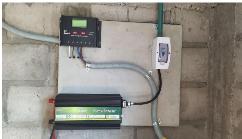
Fig. 92 conexión del tablero de mando, paneles solares, controlador de carga, inversor y breaker. (Autor)
