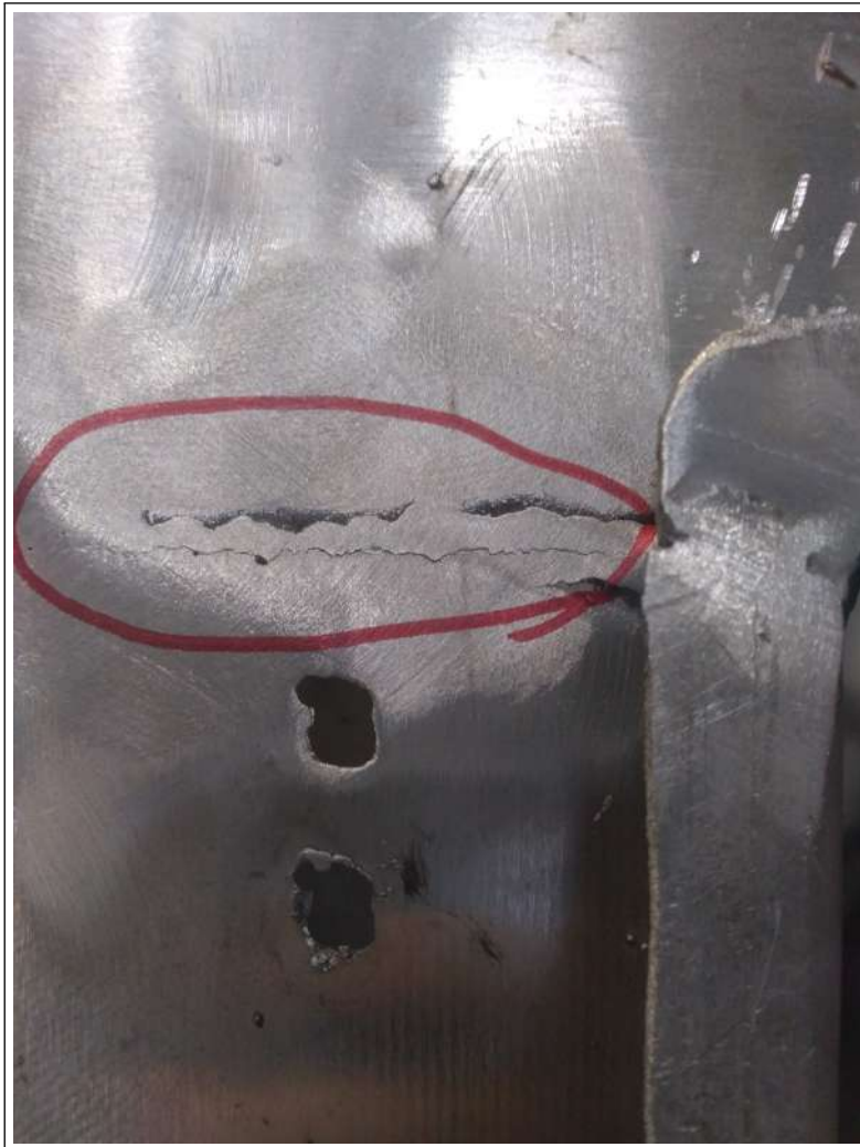
Figura 7.3: Fisura en soldadura. [Autor].
