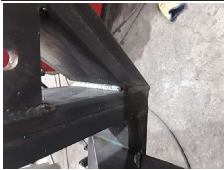
Figura 7.8: Discontinuidad en soldadura. [Autor].
