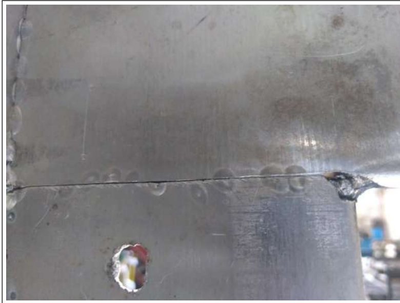
Figura 7.6: Falta de penetración de soldadura. [Autor].
