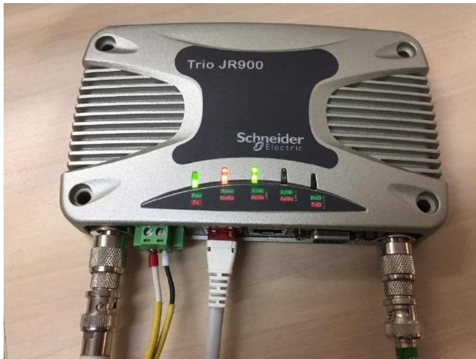
Ilustración 91 Radio modem instalado y energizado.
