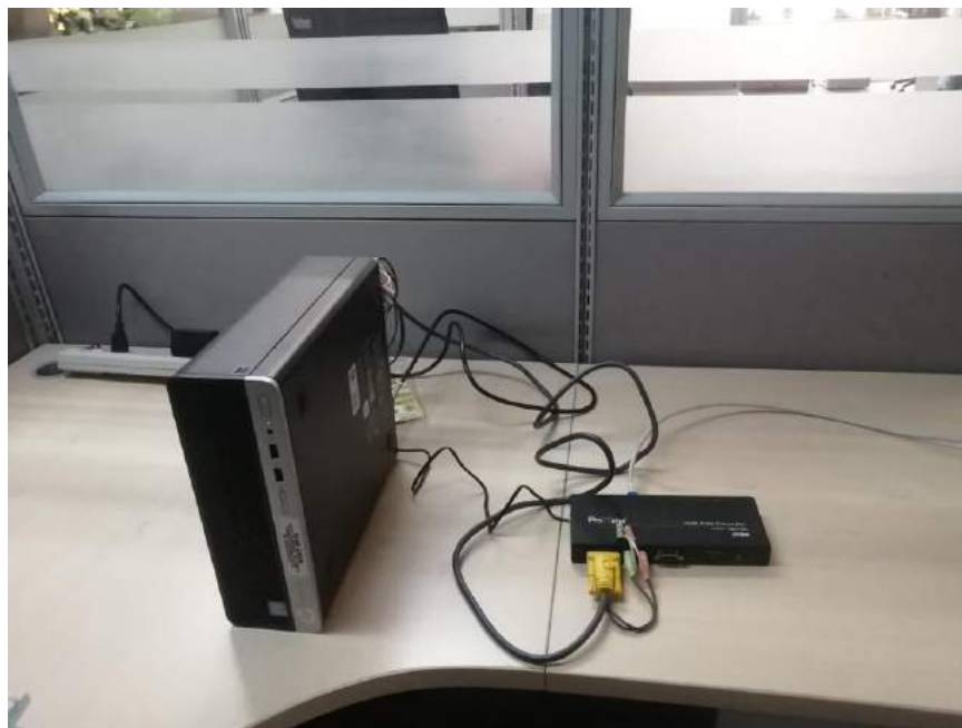
Ilustración 96. montaje de extensor KVM con CPU
