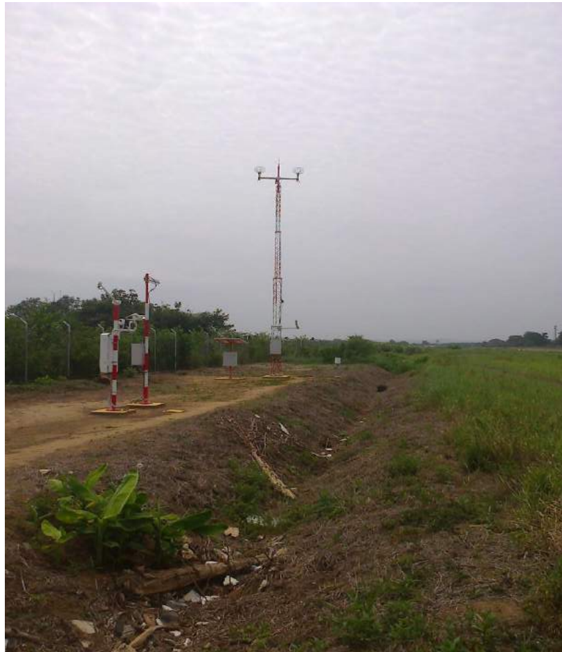
Ilustración 13 Torres suministro de energía
