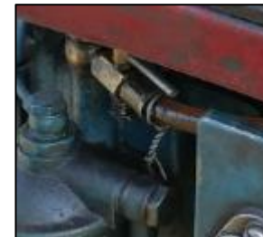
Línea de combustible. Manguera de alimentación (entrada)
