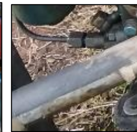
Soporte de línea Salida de combustible, filtro a motor Diesel.
