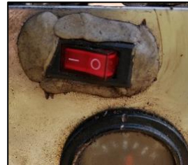
Switch N.A Acciona los ventiladores de forma simultánea.
