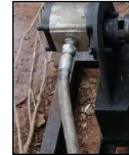
Bomba hidráulica. Sujeta a cama-base antivibración.
