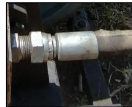
Acople en tanque.
