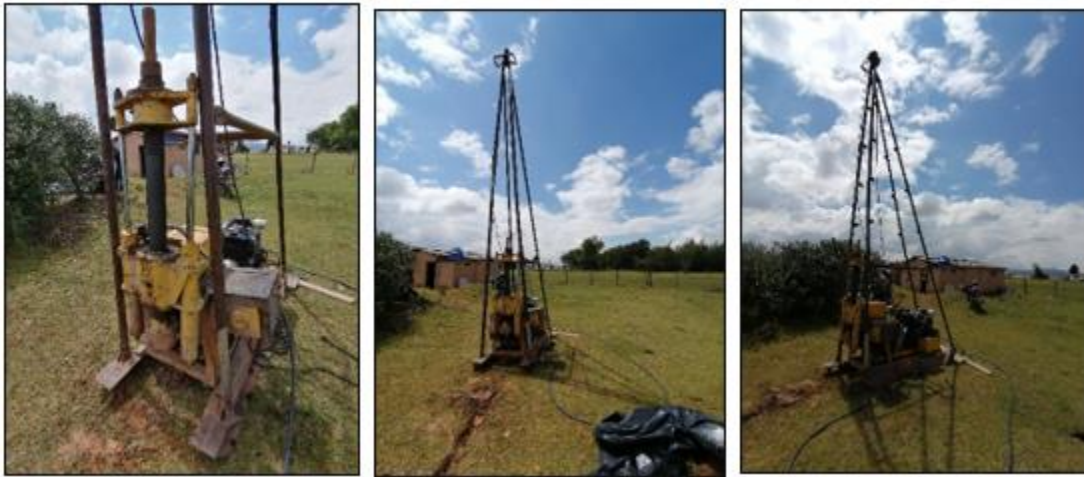
Ilustración 18 Estructura en máquina
