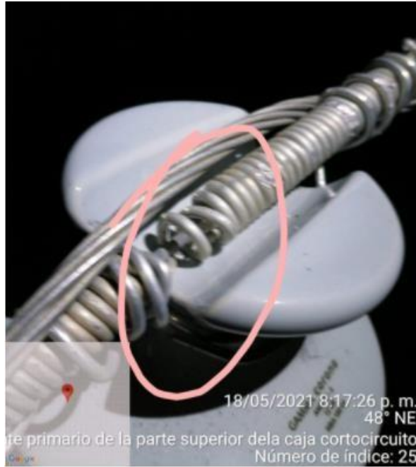
Ilustración 46 Fallas Encontradas en Terreno
