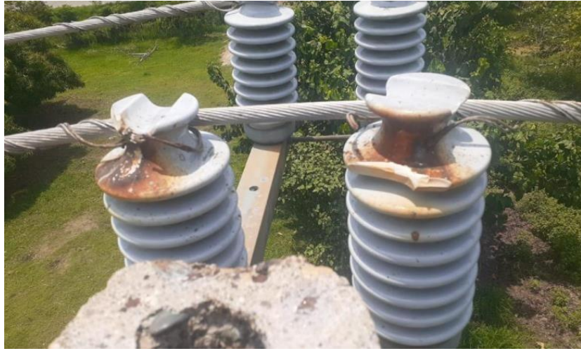
Ilustración 9 Inspección visual, daño
