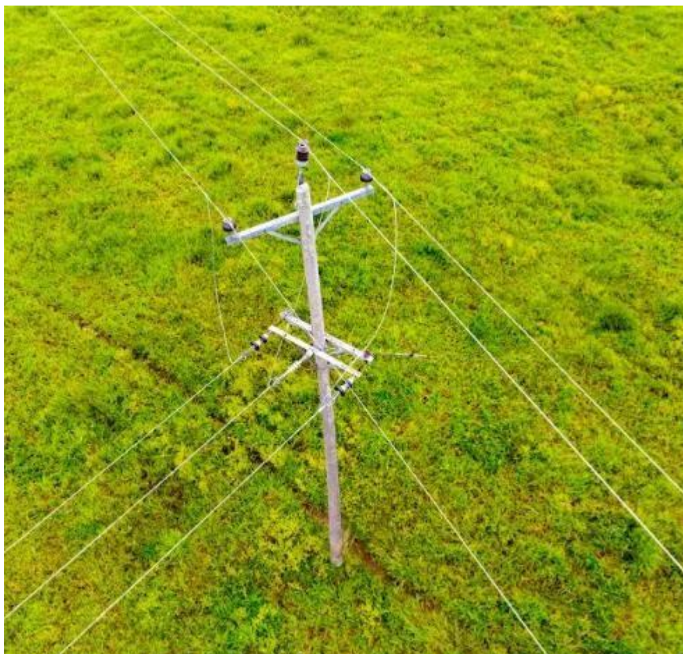
Ilustración 24 Supervisión área por media tensión
