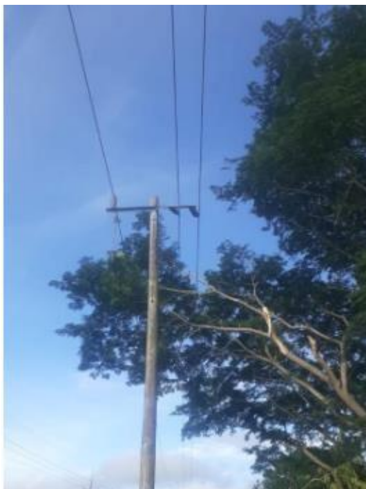
Ilustración 44 Fallas Encontradas en Terreno
