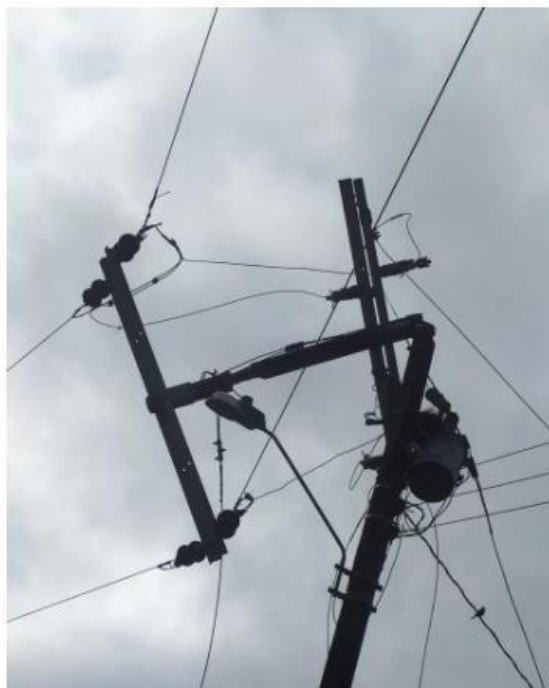
Ilustración 45 Fallas Encontradas en Terreno
