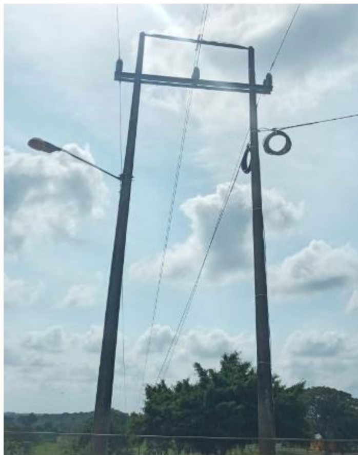
Ilustración 8 Inspección visual, posible daño
