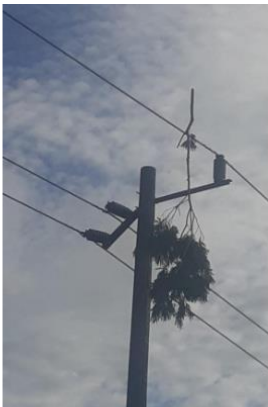
Ilustración 43 Fallas Encontradas en Terreno
