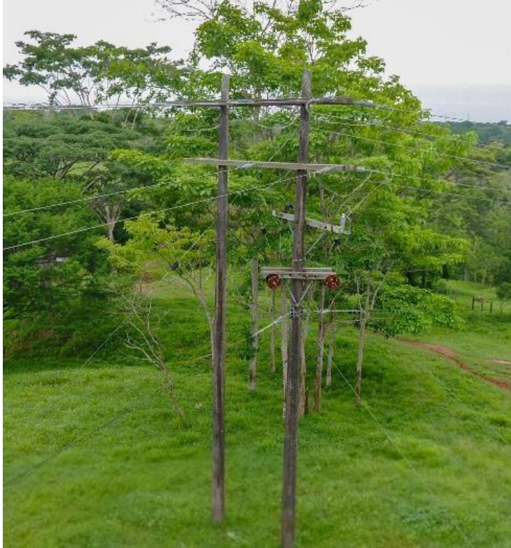
Ilustración 21 Crucetas en mal estado
