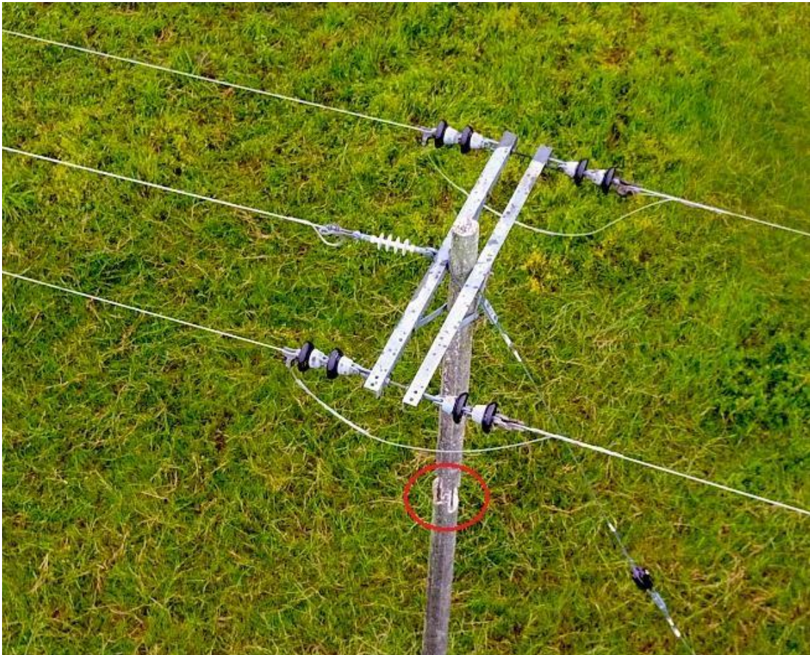
Ilustración 25 apoyo en mal estado
