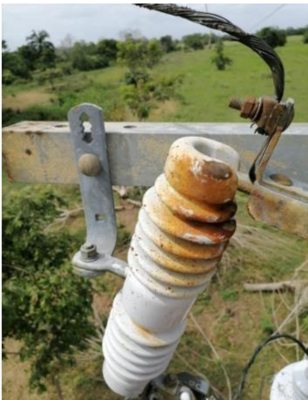
Ilustración 42 Fallas Encontradas en Terreno
