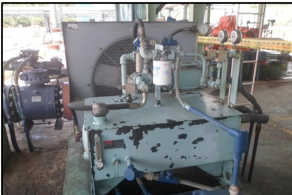
Figura 86. Fotografía de la unidad de bombeo principal 2430 que se encontraba en preservación. Elaboración propia
