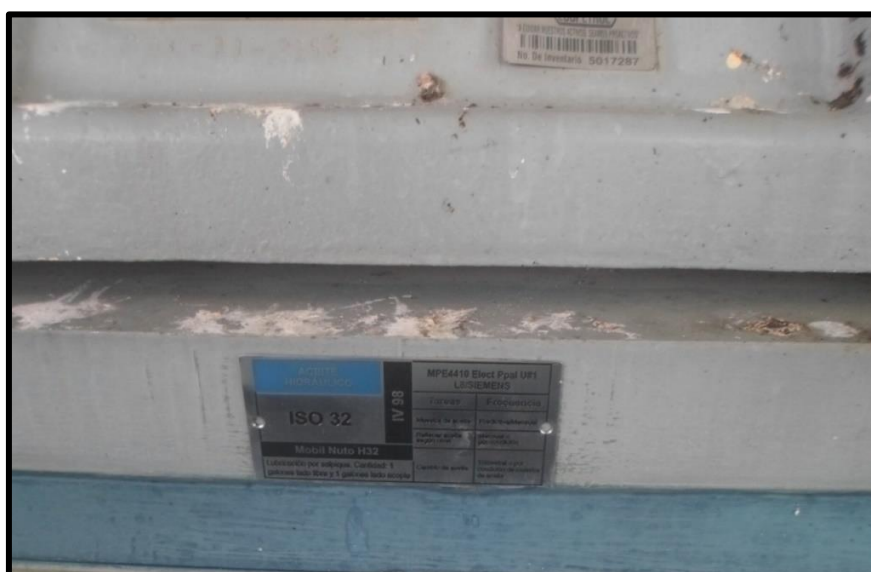
Figura 88. Rótulo de lubricación instalado en un activo de las instalaciones. Elaboración propia
