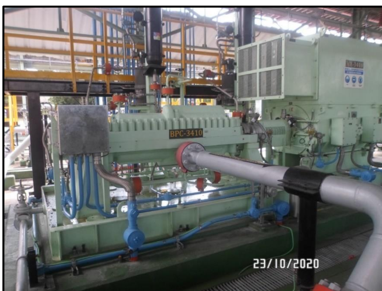
Figura 48. Bomba centrífuga principal BPC-3410 estación Puerto Salgar. Fuente: Base de datos de Stork
