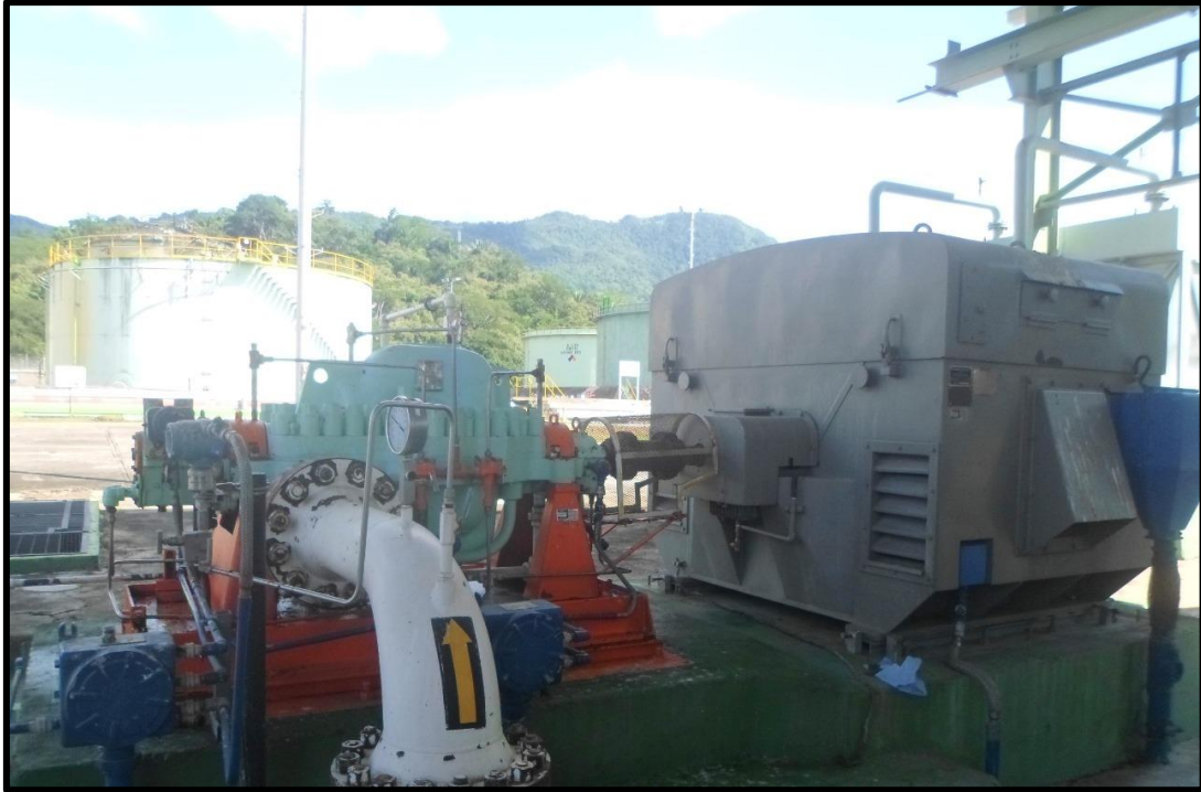
Figura 93. Fotografía unidad de bombeo principal 7420. Elaboración propia
