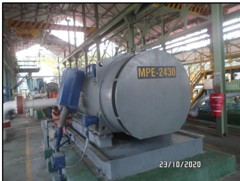
Figura 30. Motor eléctrico principal MPE-2430 estación Puerto Salgar. Fuente: Base de datos de Stork
