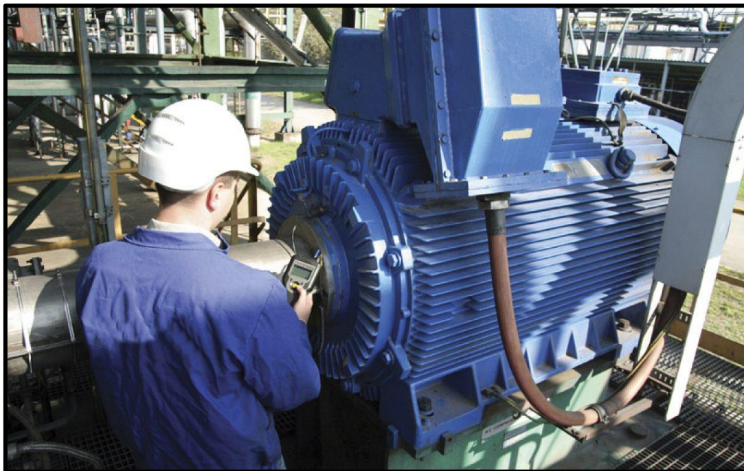
Figura 8. Monitoreo a un motor eléctrico principal. Fuente: Base de datos de Stork
