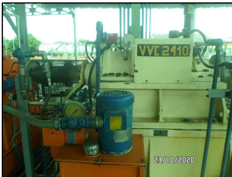
Figura 33. Variador de velocidad VV-2410 estación Puerto Salgar. Fuente: Base de datos de Stork
