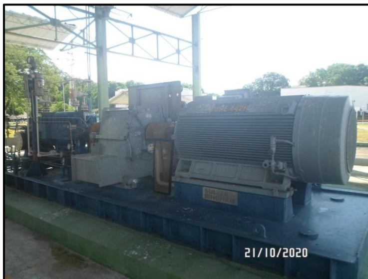
Figura 27. Unidad de bombeo principal de GLP estación Puerto Salgar. Fuente: Base de datos de Stork
