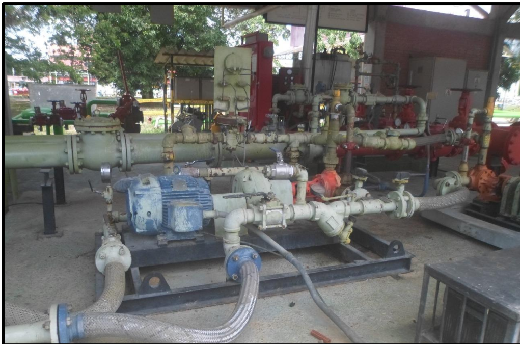
Figura 92. Unidad de sistema contra incendio (SCI) de extinción con espuma de la estación. Elaboración propia
