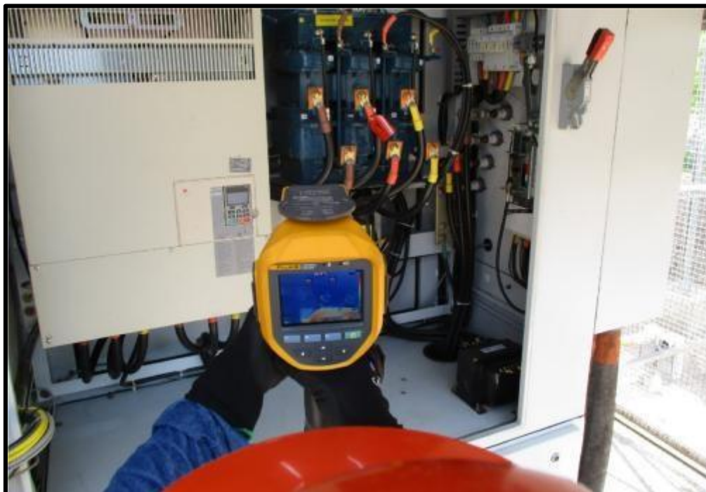
Figura 89. Termografía aplicada al sistema de control de las unidades principales, tomada en el cuarto de control de máquinas o CCM. Elaboración propia
