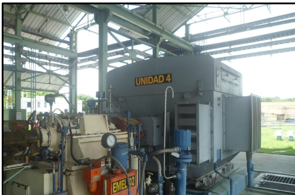
Figura 90. Fotografía unidad de bombeo principal 2440. Elaboración propia
