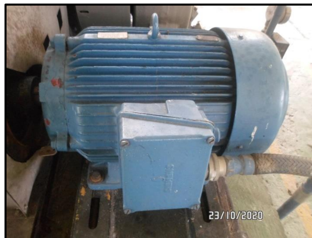
Figura 6. Fotografía del motor eléctrico de baja tensión de la unidad de compresión de aire de la estación. Fuente: Base de datos de Stork
