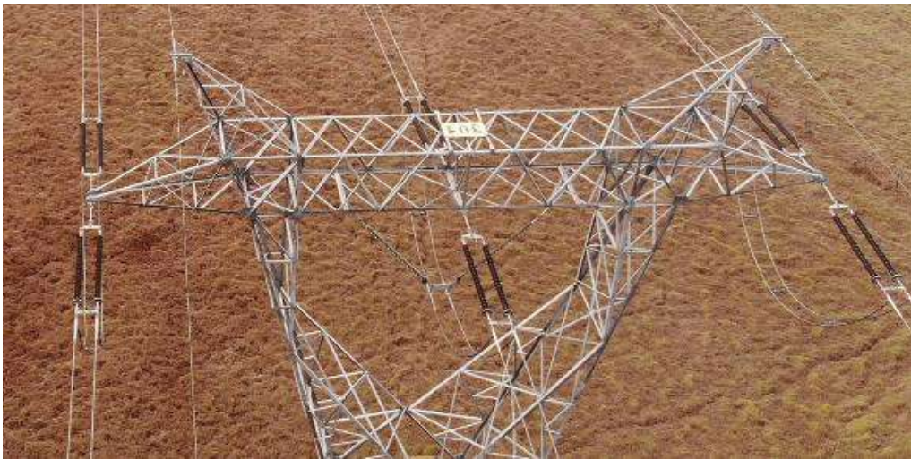
Figura 3.14: Infraestructura eléctrica de alta tensión desde una vista superior
