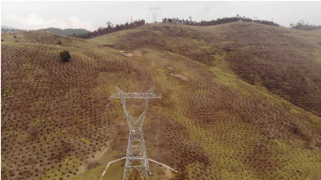
Figura A.3: Imágenes de líneas de alta tensión tomadas usando drones para visualización de torres eléctricas de manera lejana
