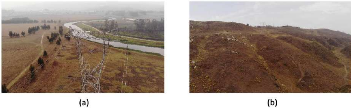
Figura 5.1: (a) Inspección sobre la infraestructura eléctrica (b) Inspección sobre la líneas eléctricas de alta tensión y vista lejana de torres eléctricas
