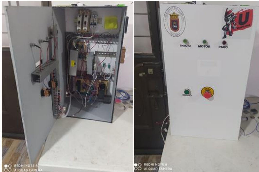
Figura 57. Panel de control en su fase final.
