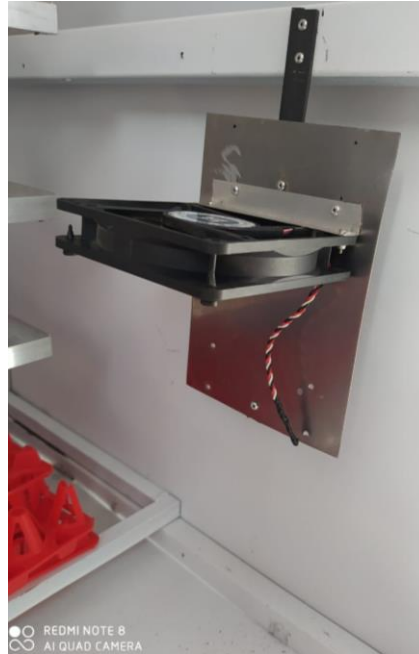
Figura 52. Ventilador en su Bases.
