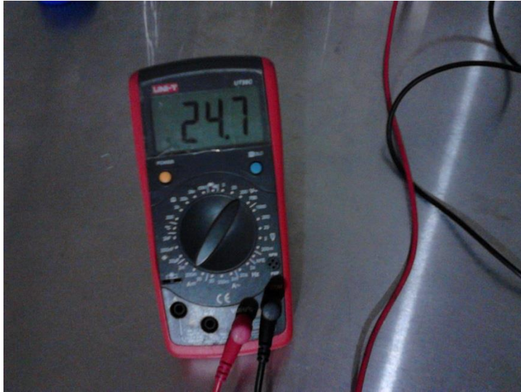
Imagen 42. Medición de tierra en la red
