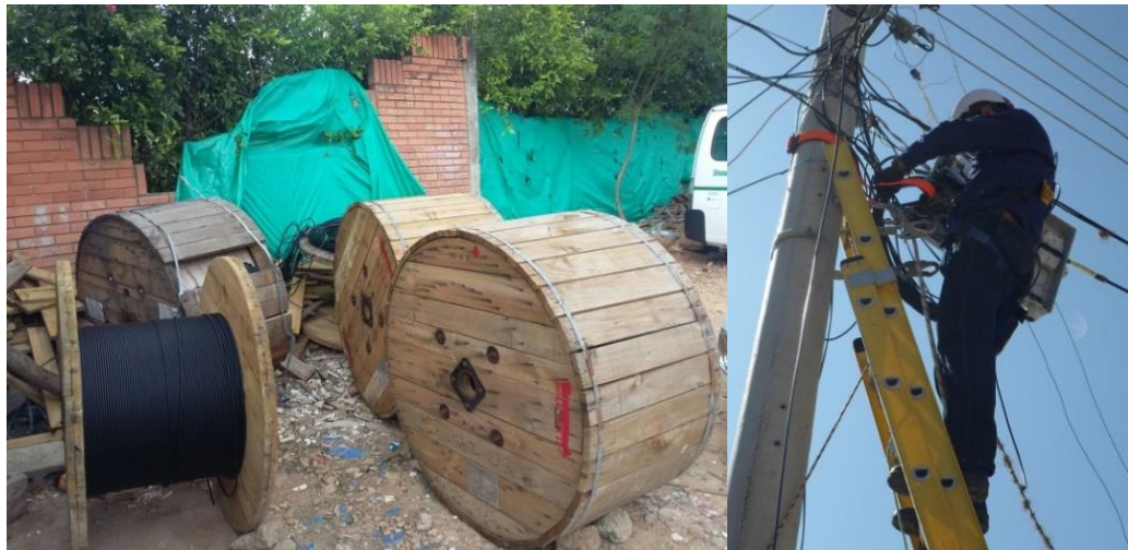
Figura 44. Fibra óptica y Anclaje en el poste.
