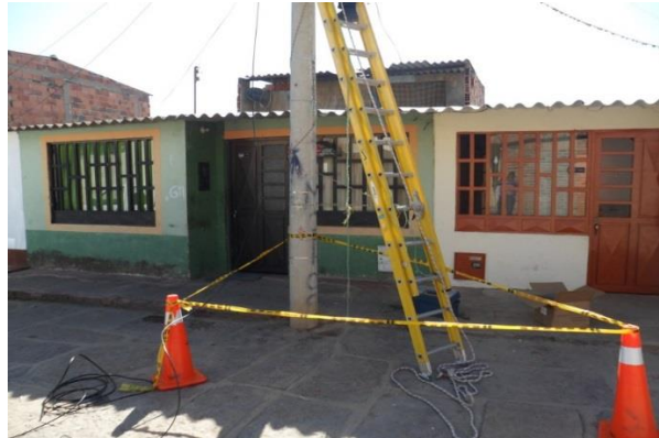
Figura 41. Poste en buen estado con demarcación del área de trabajo.
