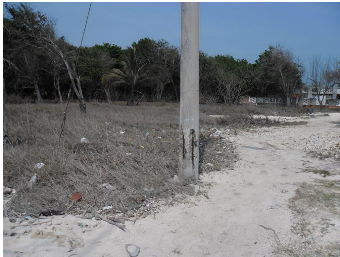
Figura 40. Poste en mal estado
