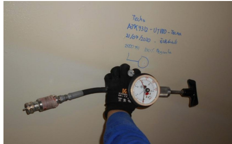
Figura 6.6: Toma de medida de adherencia con equipo hidráulico Fuente: UT VRO / ECP
