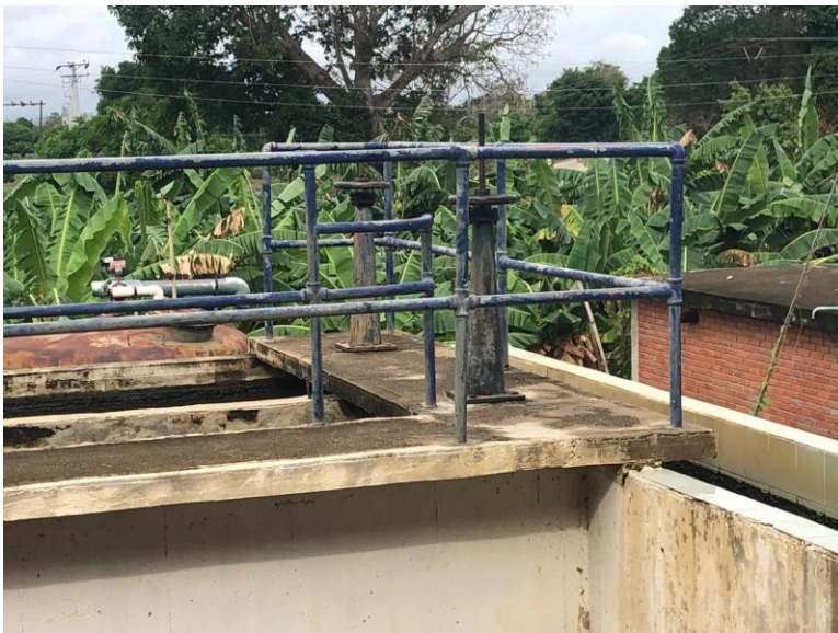
Figura 35 Válvulas final de desarenadores.
