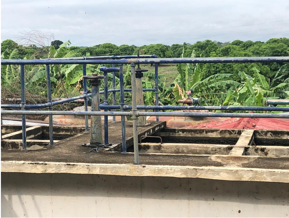
Figura 36 Válvulas central de desarenadores.
