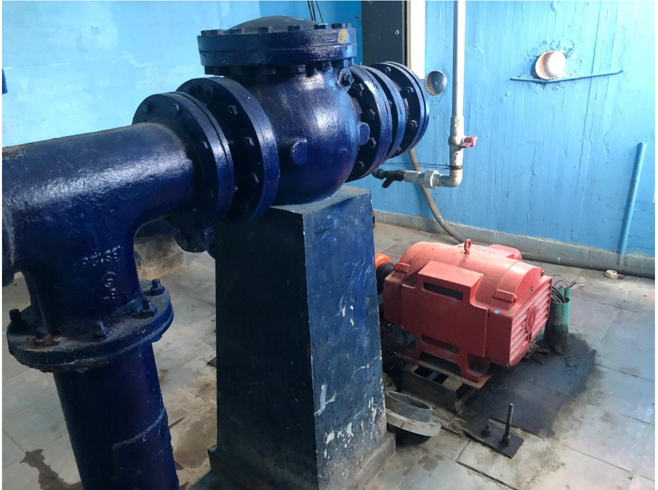
Figura 29 Motor para distribución zona alta.
