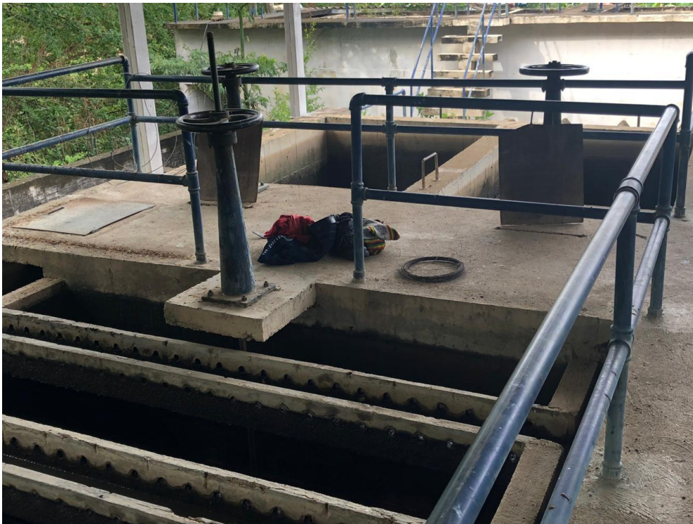
Figura 39 Válvulas de sedimentador izquierdo.
