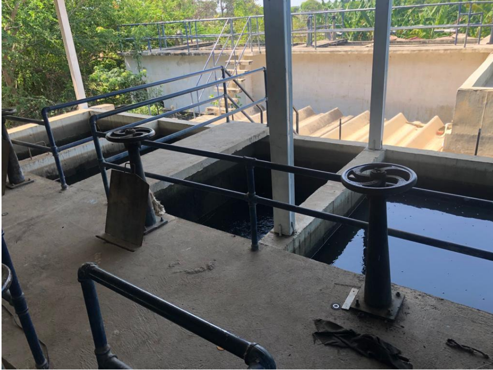
Figura 38 Válvulas de filtros.
