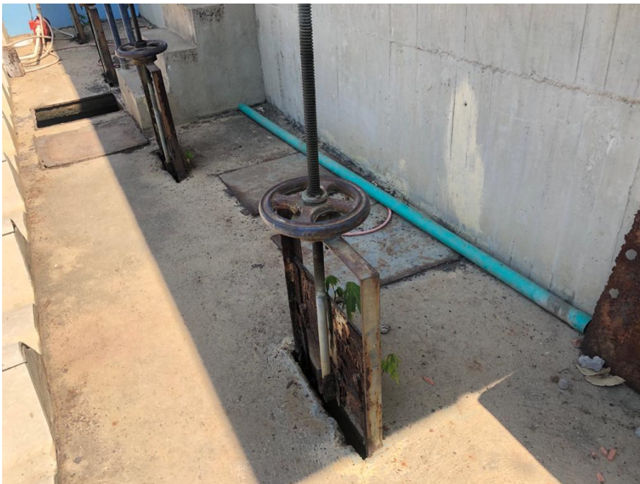
Figura 37 Válvulas de tanque almacenamiento.
