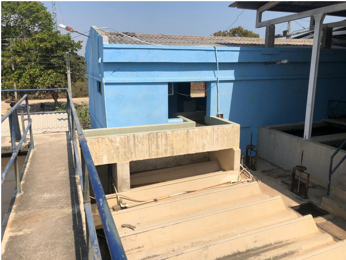
Figura 22 Inicio de canal Parshall.
