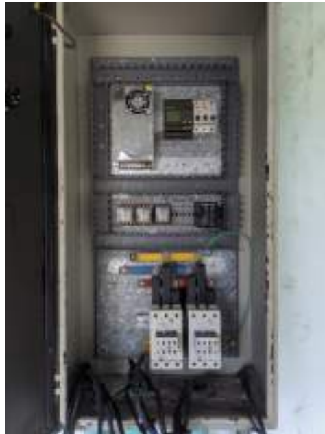
Figura A.4: Montaje de los componentes en el tablero de control
