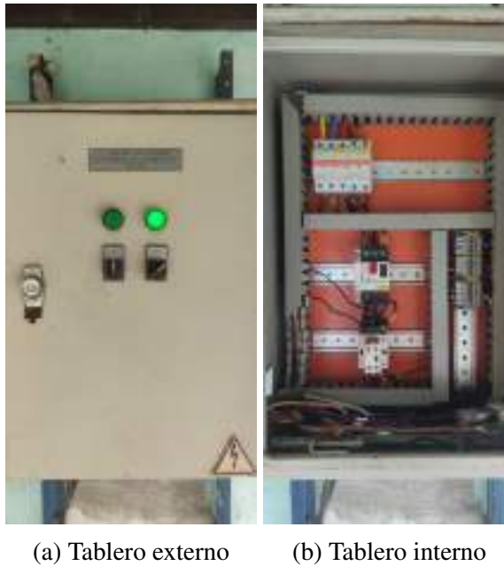
Figura 4.13: Tablero de control asignado a la estación de bombeo y succión zona noreste.
