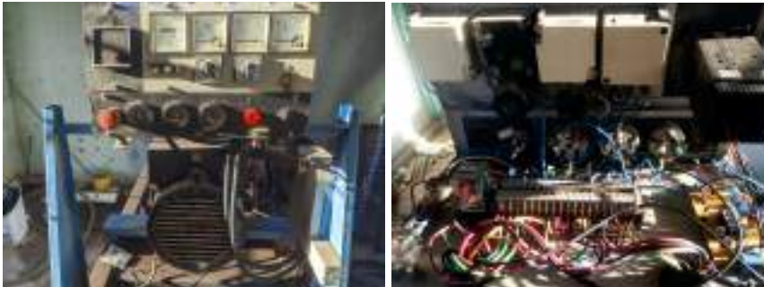
(a) Grupo electrógeno.
