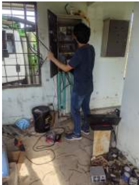
Figura A.1: Test del tablero de control
