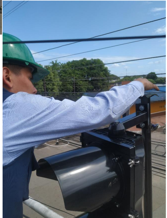
Figura 32. Subida y Adaptación de semáforo, Ensamble con el nuevo adaptador para el evitar un nuevo derribamiento.
