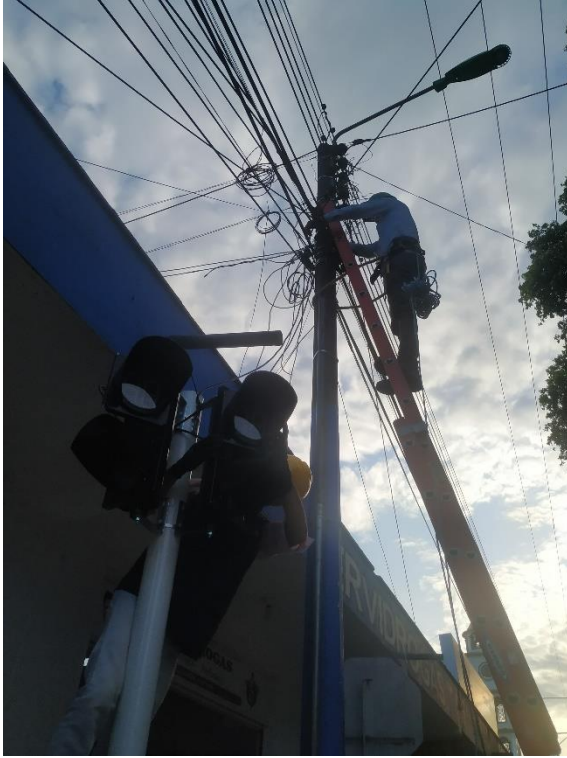
Figura 44. Conexión Eléctrica, Conexión para la alimentación de los semáforos desde la red de alumbrado público.
