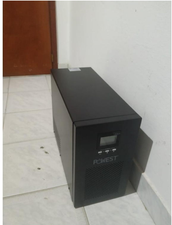
Figura 17. UPS 3KVA, Verificación del estado y recibimiento por parte del funcionario de la alcaldía.
