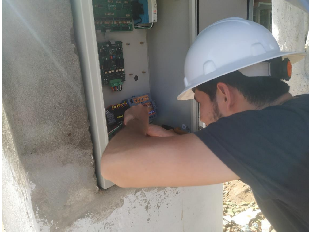
Figura 56. Instalación y conexión, Conexión de los dispositivos en la nueva caja de control.
