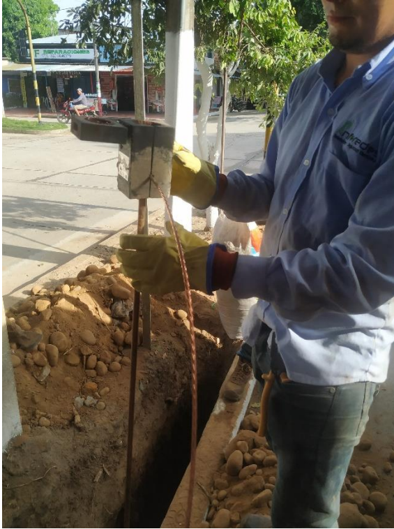
Figura 50. Preparación fundición del cable, Preparación de cable con la varilla para función y vertimiento de los químicos necesarios.
