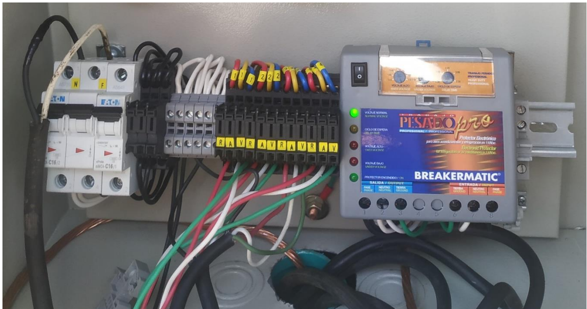
Figura 5. Etapa de alimentación, Composición de izquierda a derecha de la etapa de alimentación: Breacker, Fusibles, Protector de voltaje.
