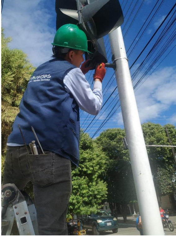
Figura 33. Cambio y Sondeo del nuevo cable, Sondeo del nuevo cable y preparación para la conexión con caja de control.
