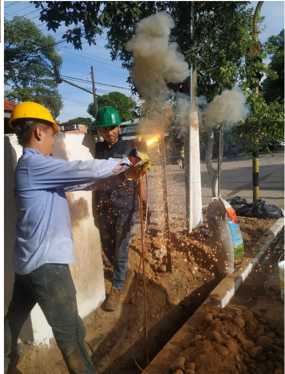
Figura 51. Fundición “disparo” de puesta a tierra, Fundición a altas temperaturas entre el cable y la varilla que servirá como polo a tierra eléctrico.
