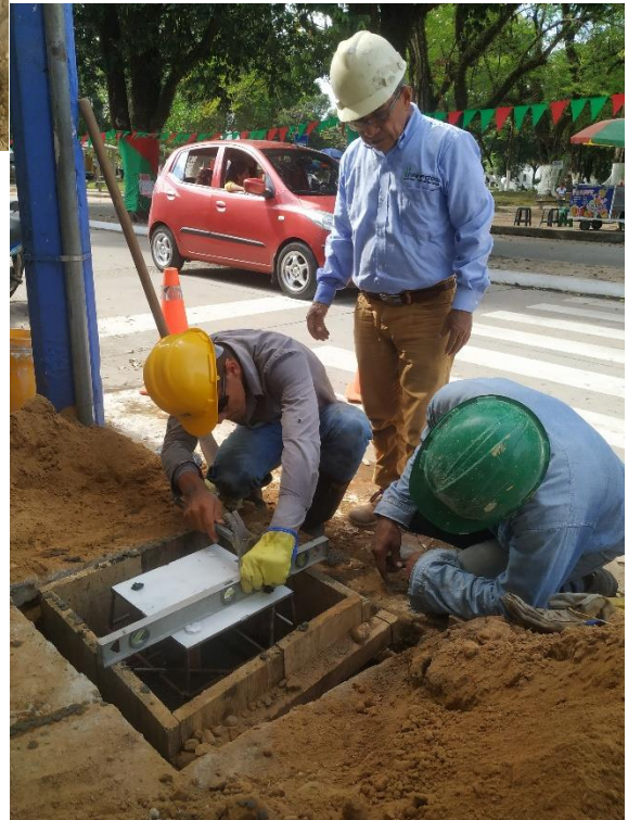
Figura 41. Instalación de canastillas, Instalación de la canastilla a nivel para posterior fundición en concreto.
