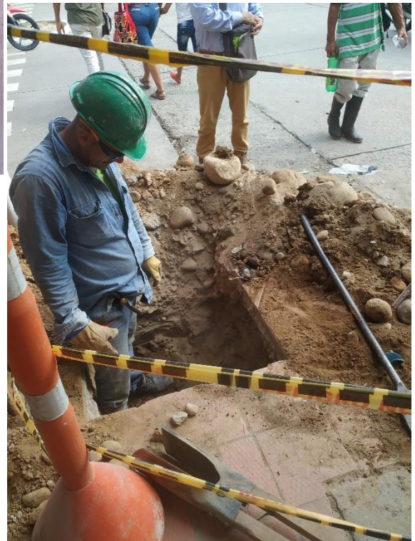
Figura 39. Excavación para la instalación del mástil, Excavación en punto de instalación para semáforo peatonal de 60x60x70 cm.
