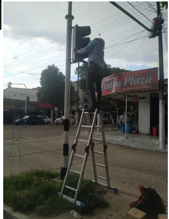
Anexo 59. Revisión de Segundo Cruce, Desconexión de la lámpara que presenta fallas.
