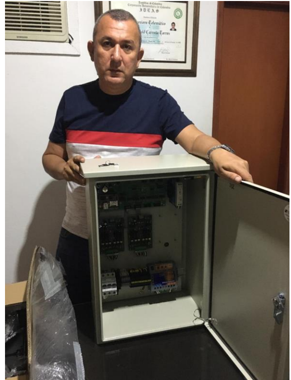
Figura 15. Caja de control, Supervisión de la nueva caja de control por parte de funcionario de la alcaldía municipal.
