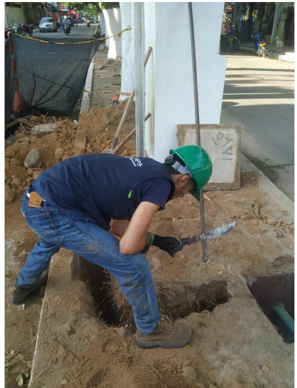
Figura 55. Sondeo cable de alimentación, Instalación del cable de cobre para la conexión en caja de control.
