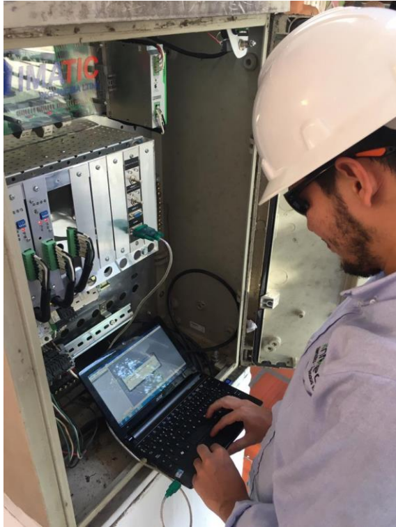
Figura 38. Mantenimiento Y Programación, Revisión de la programación ante conflictos con nuevos cruces peatonales.
