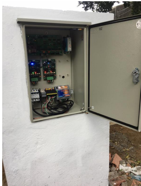
Figura 57. Pruebas de funcionamiento, Encendido y pruebas de funcionamiento para los componentes.
