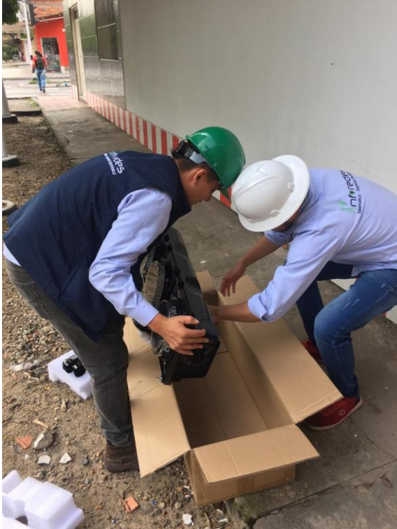
Figura 20. Revisión y ensamble de semáforo vehicular, Verificación del estado en el que llegó el dispositivo y ensamble para instalación.
