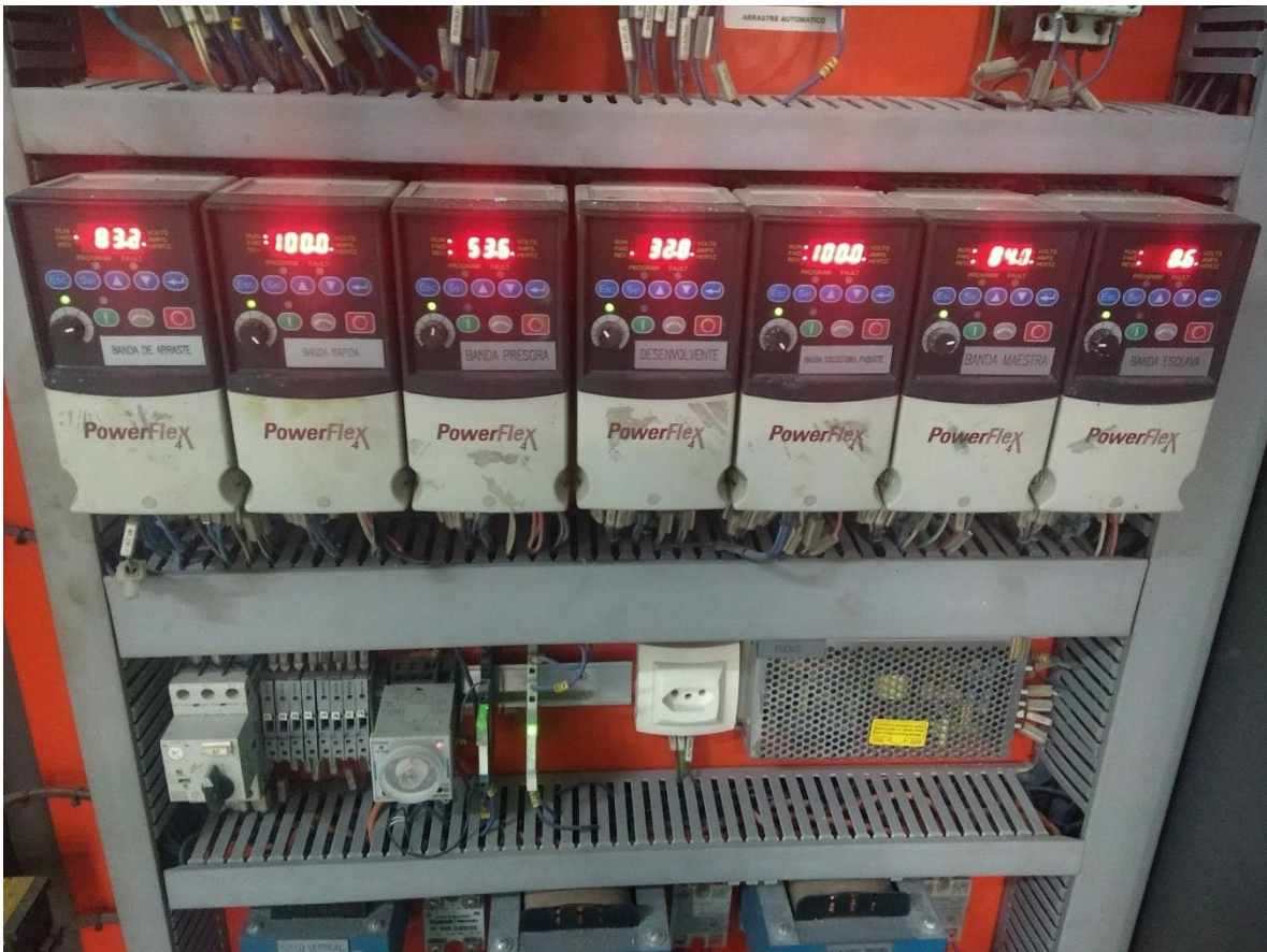
Figura 16. Variadores de velocidad.
