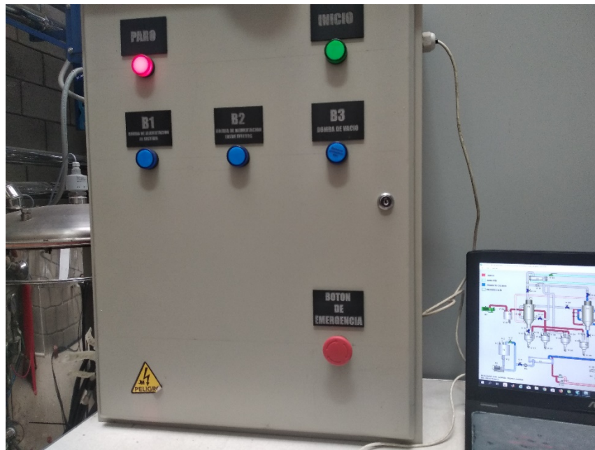
Figura 49. Verificación, paro de emergencia
