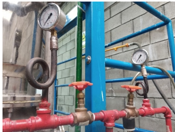
Figura 52. Válvulas de entrada del vapor
