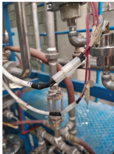
Figura 44. Conexión, sensores de nivel
