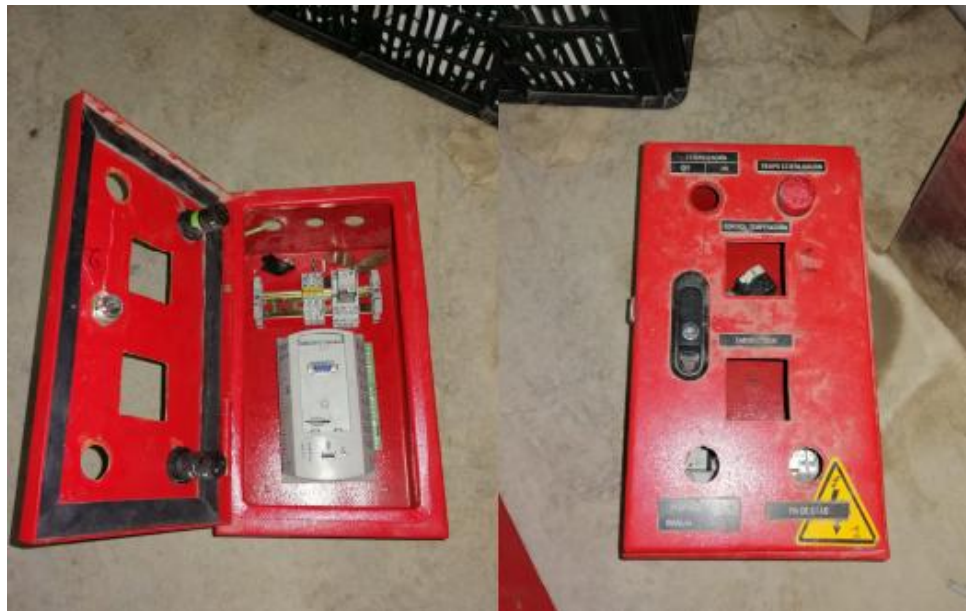
Figura 59. A la izquierda se evidencian los principales componentes internos; y a la derecha el exterior de la caja de control por fuera sin los controladores de temperatura, indicadores y pulsadores. (Fuente: Autor).
