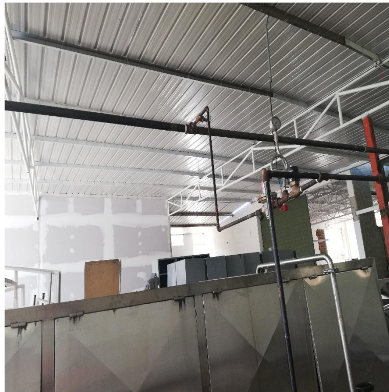
Figura 29. Línea de condensado lavado por escobillas y agua. (Fuente: Autor).
