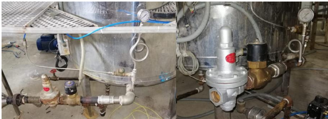
Figura 60. Instrumentación necesaria para la entrada de vapor de las autoclaves. (Fuente: Autor).
