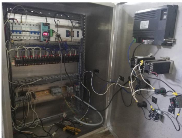
Figura 65. Montaje del tablero de control de las autoclaves. (Fuente: Autor).
