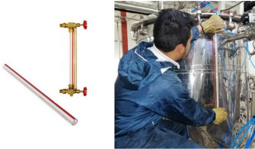
Figura 62. Tubo de vidrio indicador junto con sus válvulas de latón, instalación del tubo indicador de nivel. (Fuente: Autor).
