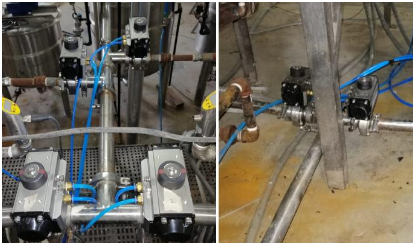
Figura 64. Válvulas superiores para la entrada de líquido, válvulas inferiores para la evacuación del líquido.
