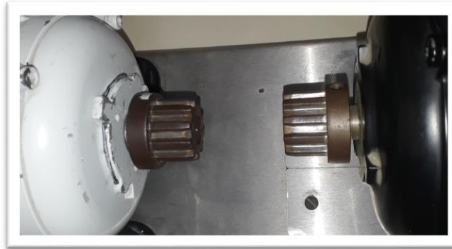
Figura 15 Acoples de motor y taco-generator. (Autor)
