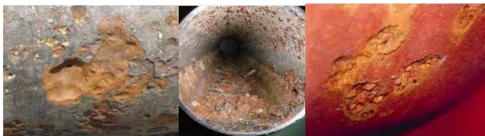
Figura 2. Corrosión en calderas de vapor
