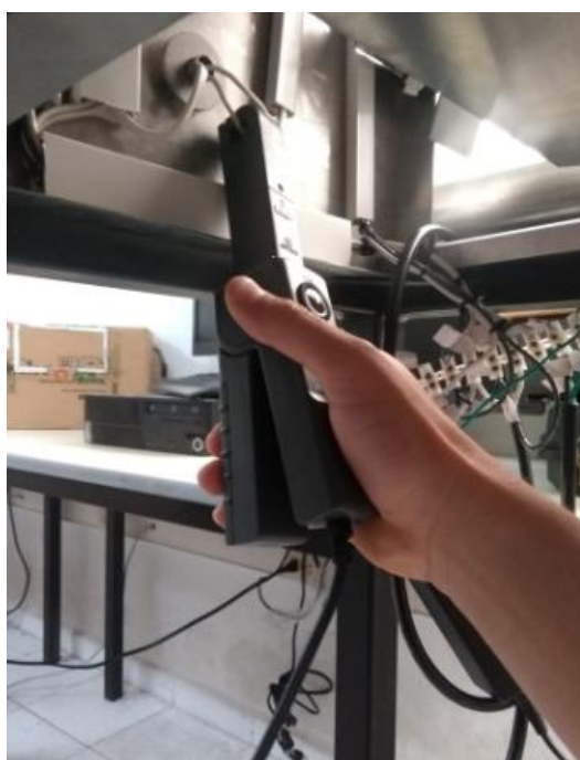
Figura 4: Medición de Amperios de la resistencia calefactora Autores
