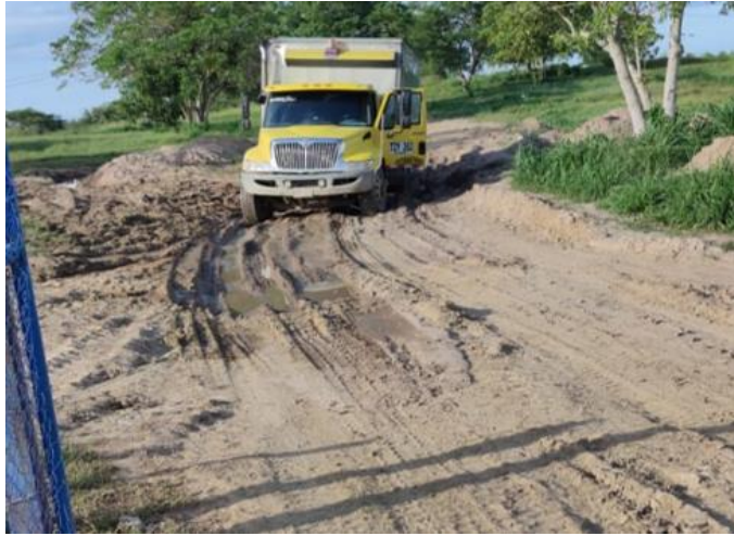
Imagen 2. Deterioro parcial que presenta las vías de acceso.
