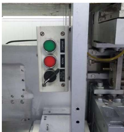
Figura. (7.4) 16: Caja de control
