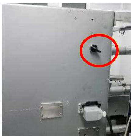
Figura. (7.7) 23: Selector de activación válvula solenoide salida en el bajante.
