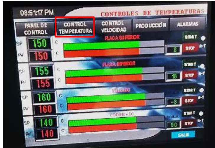
Figura. (7.10) 6: Sección control de temperaturas.
