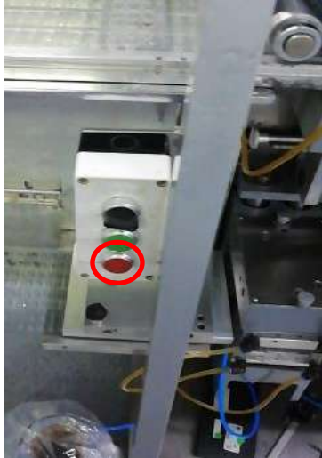
Figura. (7.2) 6: Caja de accionamiento.
