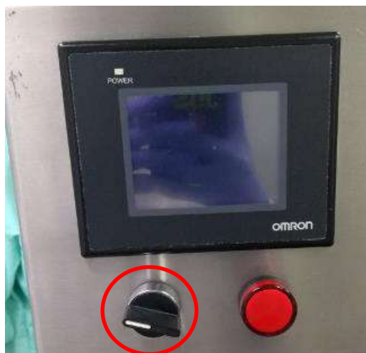
Figura. (7.3) 1: Selector en posición ON.
