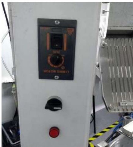
Figura. (7.7) 18: “Tablero eléctrico” estación de alimentación.
