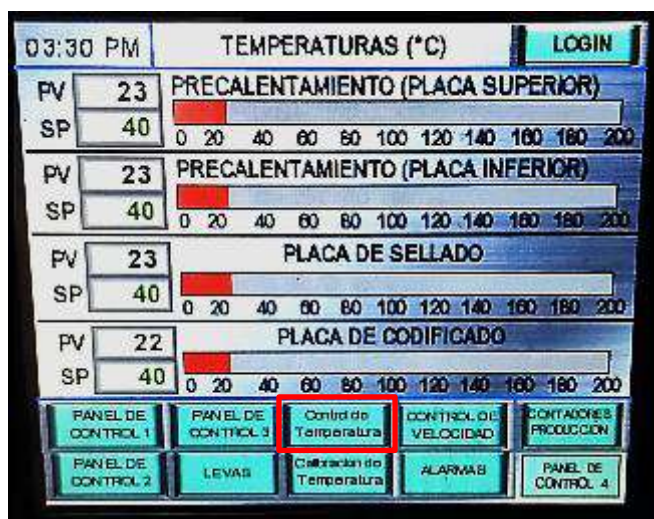
Figura. (7.9) 7: Sección control de temperaturas.
