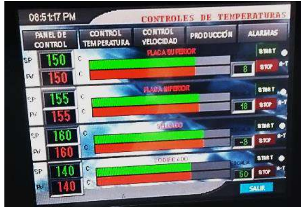
Figura. (7.13) 2: Interfaz calibración de temperaturas blistera #2 EEP-002-PD
