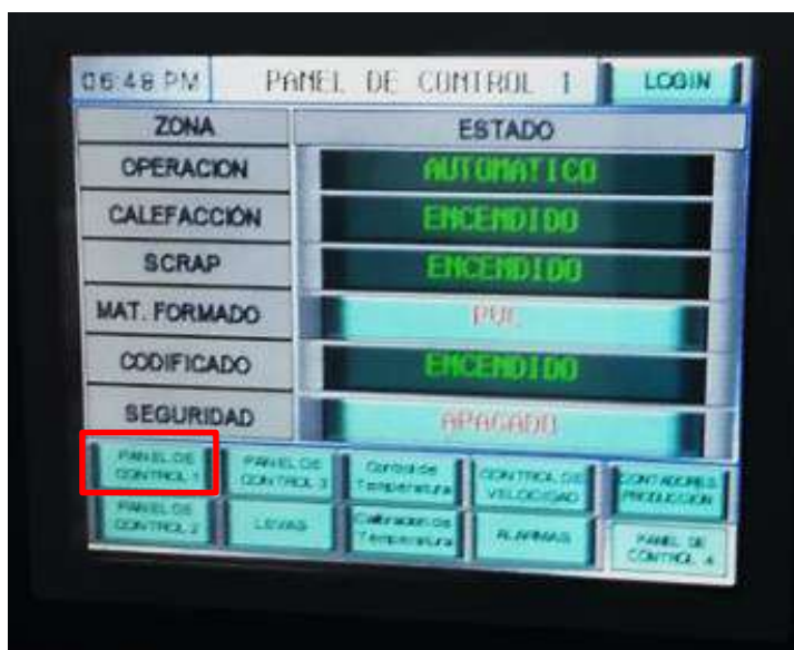
Figura. (7.9) 3: Panel de control 1 y parámetros y activación de sistemas.
