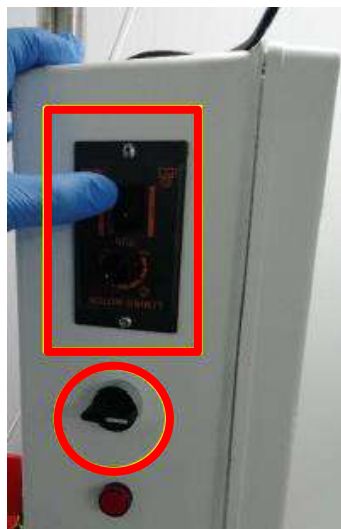
Figura. (7.7) 21: Selector y variador de velocidad en posición normal.
