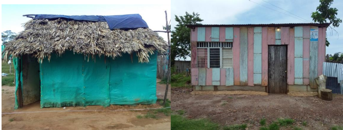
Imagen 1 Vivienda inadecuada - asentamiento los colegios Imagen 2 Vivienda inadecuada - asentamiento la ceiba
