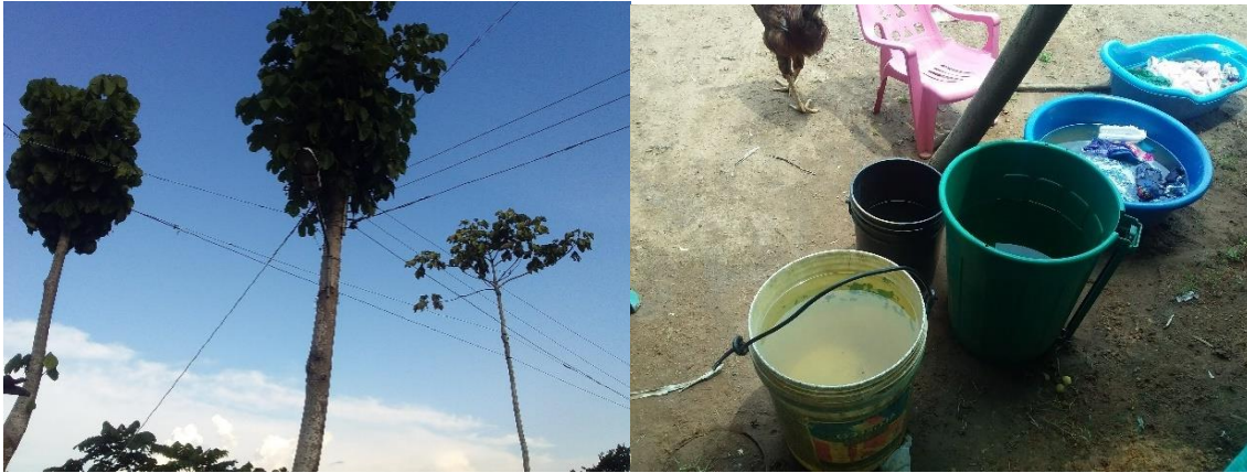
Imagen 25 Redes eléctrica de las viviendas inadecuadas
