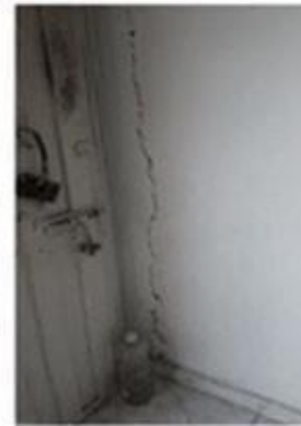
Paredes con fisura.
