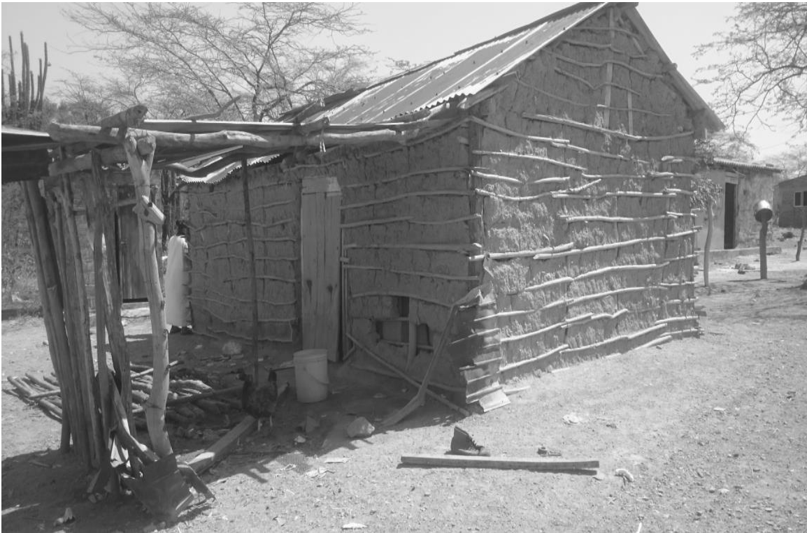
Figura. 1.5 Vivienda en bahareque deteriorada Fuente: Autor 2018.
