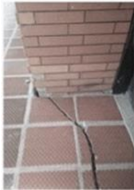
Grietas en tablón gres y aislamiento del piso de la pared.
