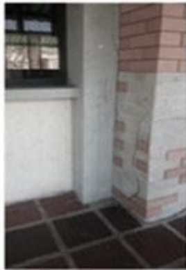
Desprendimiento de fachaletas y grietas
