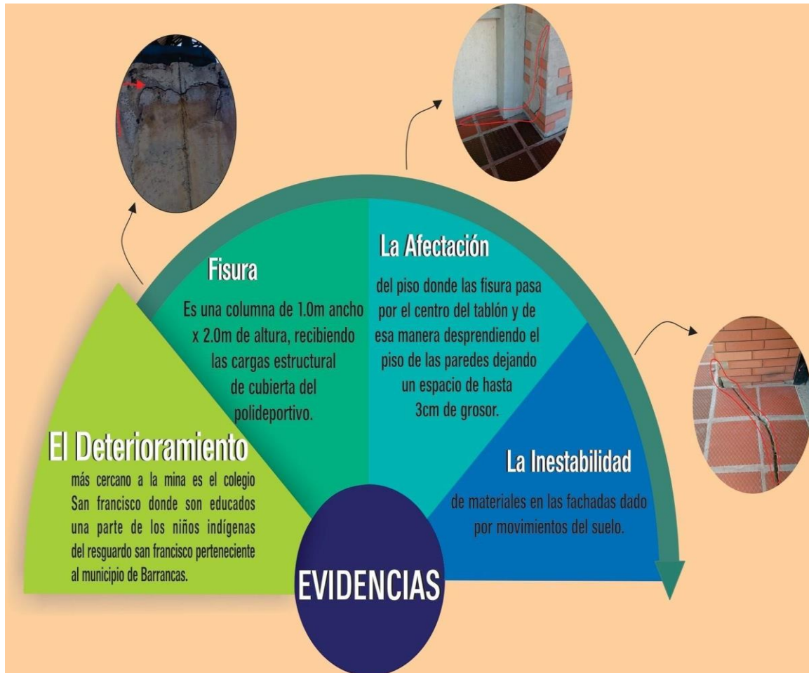
Gráfico 2. Evidencias de fisuras, resguardo San Francisco Fuente: Autor 2019.
