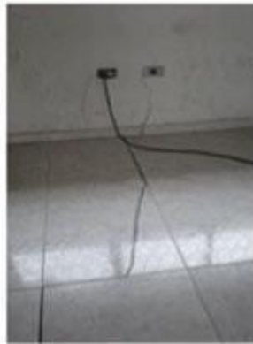
Centro de baldosa fisurada
