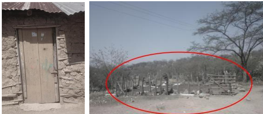
Figura. 1.7 Puerta y corral deteriorados, resguardo San Francisco Fuente: Autor 2019.
