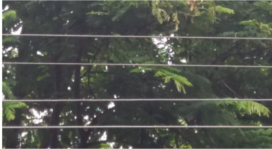
Ilustración 10: Rama próxima a la red de baja tensión, ante la presencia de aire, realiza contacto. [18]
