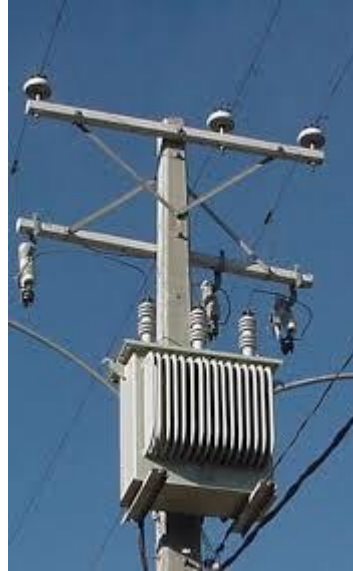
Ilustración 3: Transformador de distribución instalado en poste. [5]
