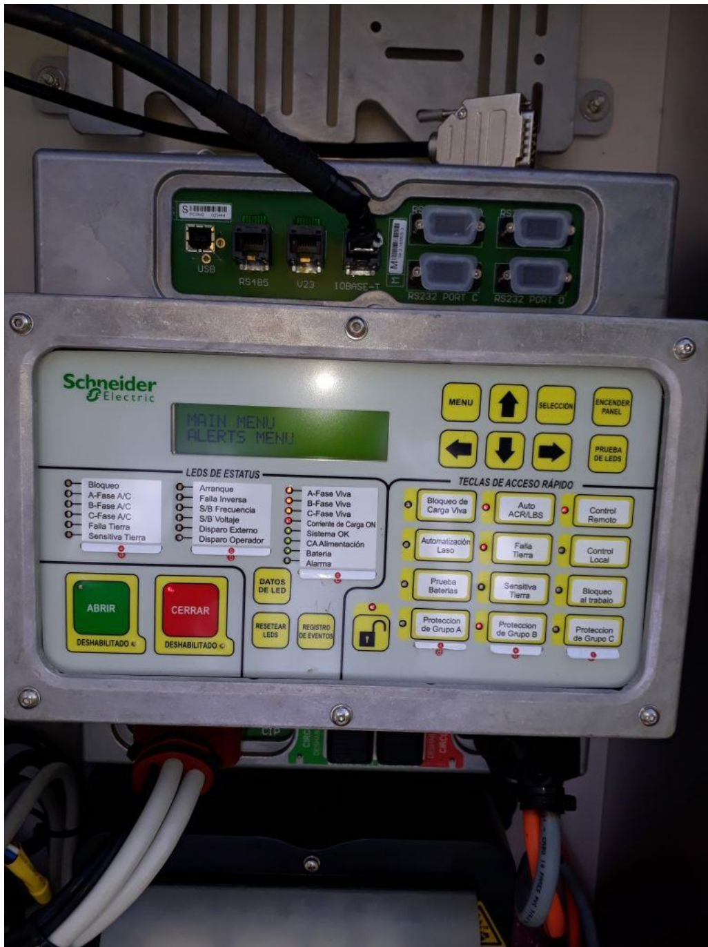
Ilustración 56: HMI de un reconectador.
