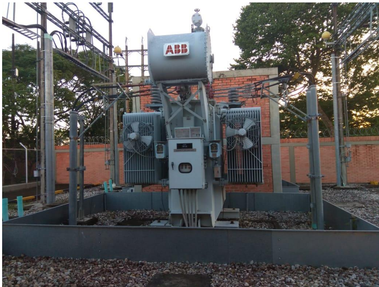
Ilustración 55: Transformador de potencia ABB de la subestación Arauca.
