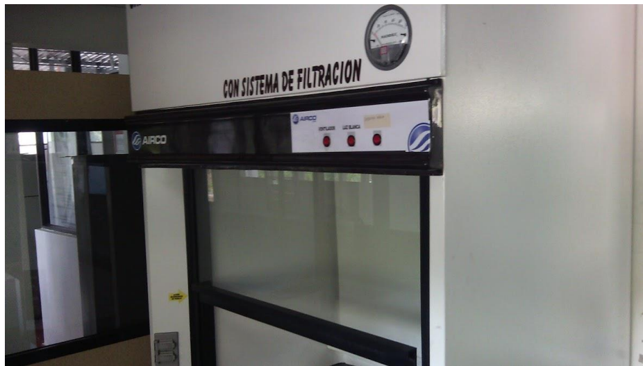
Figura 35. Control de cabina extractora
