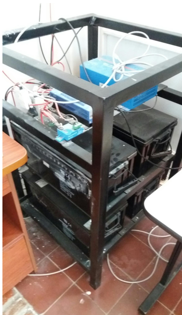
Figura 64. Sistema de paneles solares previamente instalados en el TecnoParque. Fuente: Autor.
