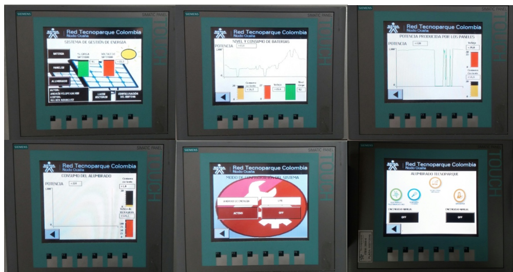
Figura 85. Pantallas con el sistema SCADA diseñado en la pantalla HMI; se puede observar la pantalla principal, la recolección de datos de las baterías, los paneles, las luces, y la configuración del sistema y el alumbrado del Tecnoparque. Fuente: Autor.
