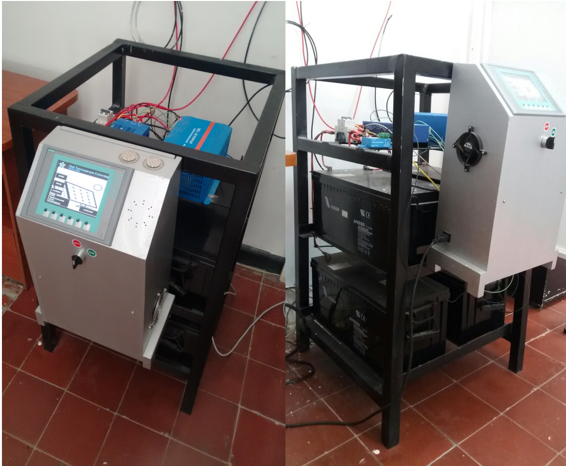
Figura 84. Instalación completa del sistema de gestión de energía junto al banco fotovoltaico. Fuente: Autor.
