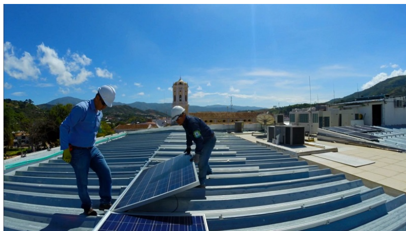
Figura 54. Instalación de paneles fotovoltaicos en la sede central de Crediservir Ocaña. Fuente: Crediservir.coop
