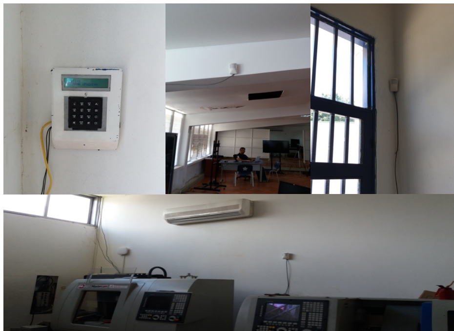
Figura 53. Instalación del sistema de seguridad en las zonas estratégicas. De izquierda a derecha; central de alarmas ubicada cerca al ingreso principal; sensor encargado de cuidar las ventanas de la línea de electrónica; sensor encargado de cuidar el ingreso por la puerta principal; en la imagen inferior se puede observar el sensor encargado de cuidar la línea de ingeniería y diseño. Fuente: Autor.
