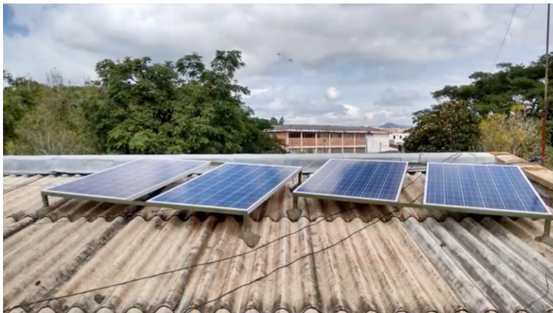
Figura 57. Bancos de paneles fotovoltaicos instalados en TecnoParque nodo Ocaña. Fuente: Tecnoparque nodo Ocaña
