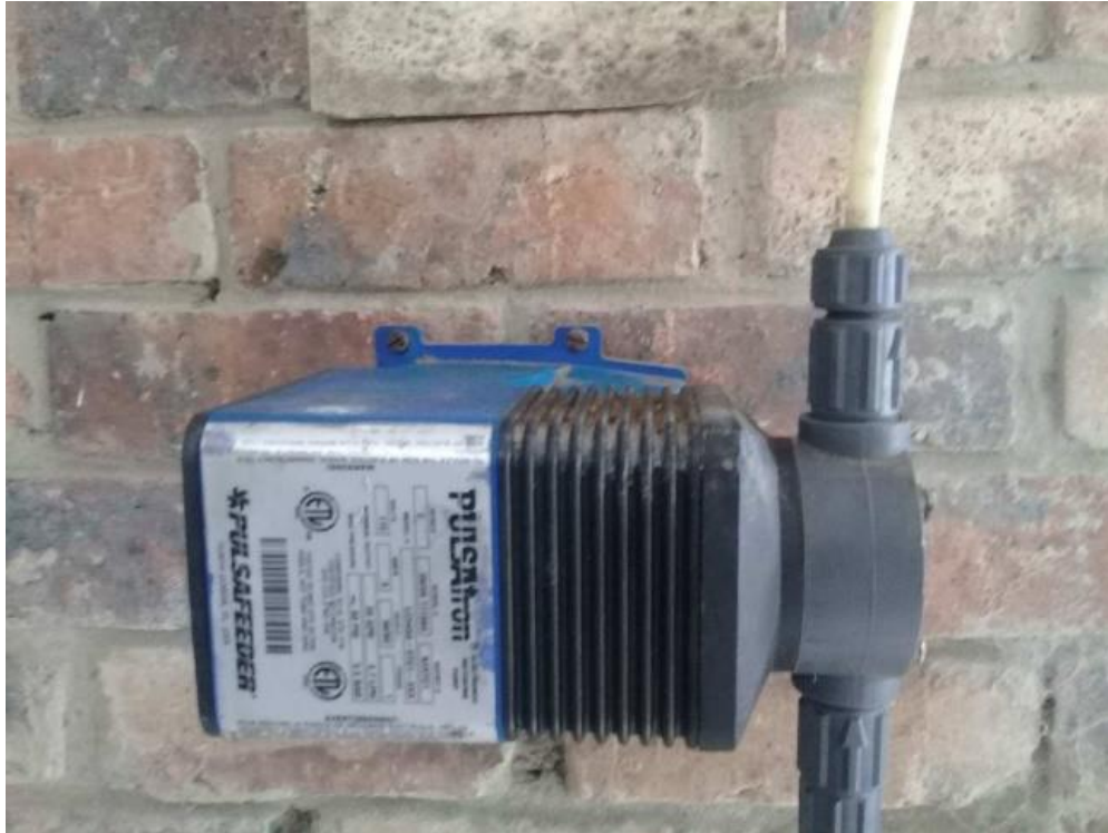
Figura 10. Bomba dosificadora de cloro
