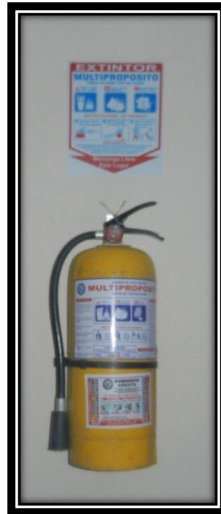
Figura 28. Protección contra el fuego.
