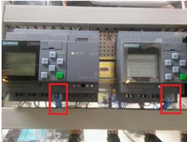
Ilustración 30 Conexión patch cord al PLC
