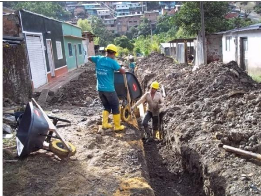
MATERIAL SELECCIONADO PARA PROTECCION DE TUBERIA
