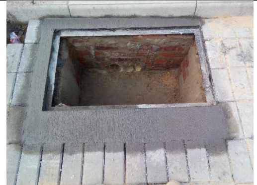
CAJA DE AGUAS LLUVIAS
