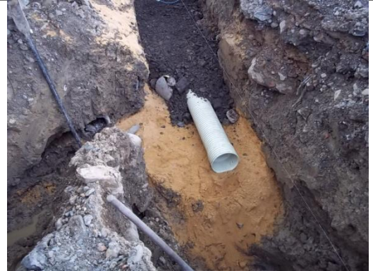
MATERIAL SELECCIONADO PARA PROTECCION DE TUBERIA
