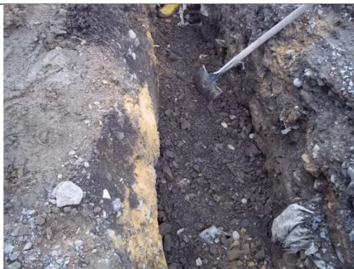
MATERIAL SELECCIONADO PARA PROTECCION DE TUBERIA
