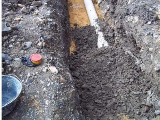
MATERIAL SELECCIONADO PARA PROTECCION DE TUBERIA
