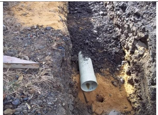
MATERIAL SELECCIONADO PARA PROTECCION DE TUBERIA
