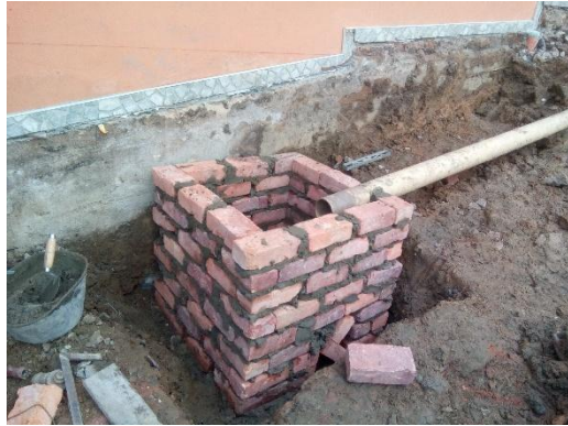
CAJAS DE INSPECCION
