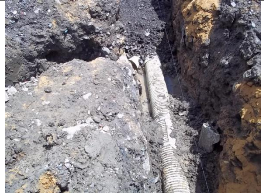
MATERIAL SELECCIONADO PARA PROTECCION DE TUBERIA
