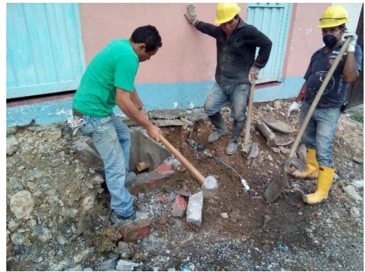
CAJAS DE INSPECCION
