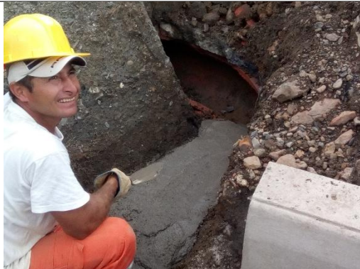
CAJA DE AGUAS LLUVIAS
