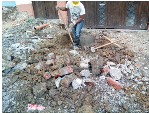
CAJAS DE INSPECCION
