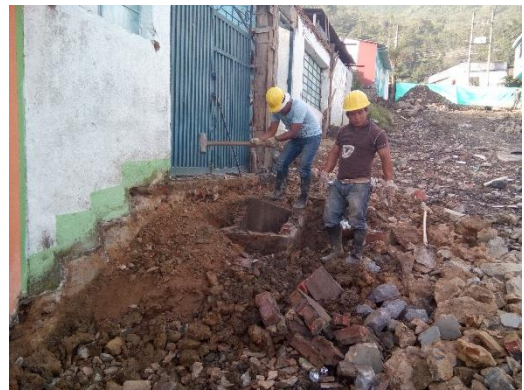
CAJAS DE INSPECCION
