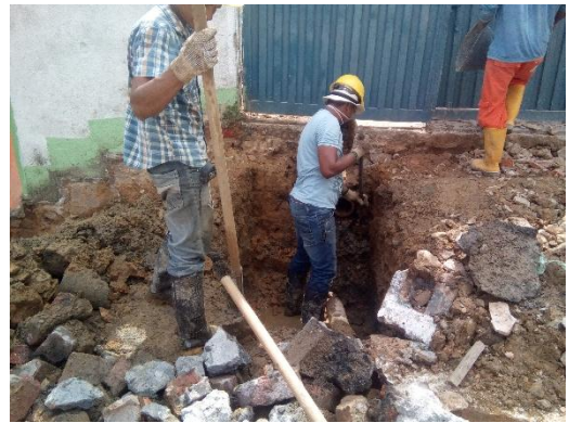
CAJAS DE INSPECCION
