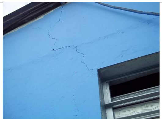
A PRIORI- CASA AFECTADA ANTES DE
