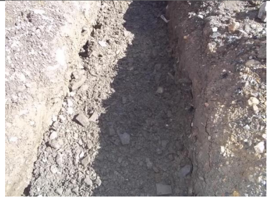
MATERIAL SELECCIONADO PARA PROTECCION DE TUBERIA
