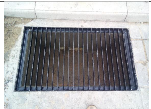
CAJA DE AGUAS LLUVIAS
