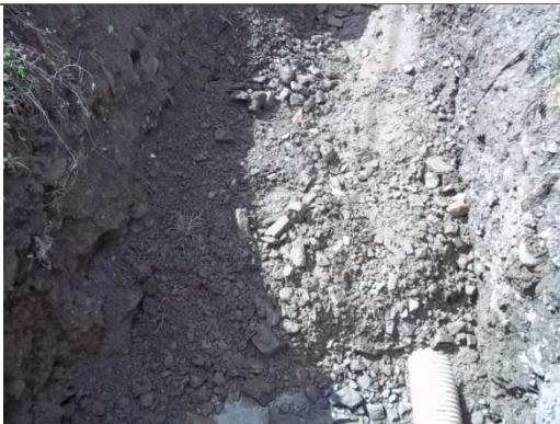
MATERIAL SELECCIONADO PARA PROTECCION DE TUBERIA
