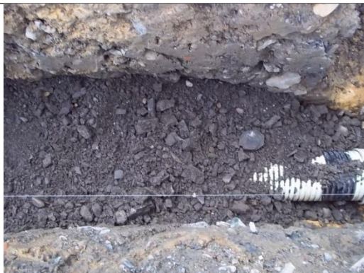
MATERIAL SELECCIONADO PARA PROTECCION DE TUBERIA
