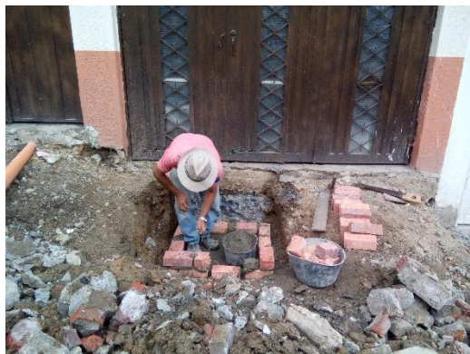
CAJAS DE INSPECCION
