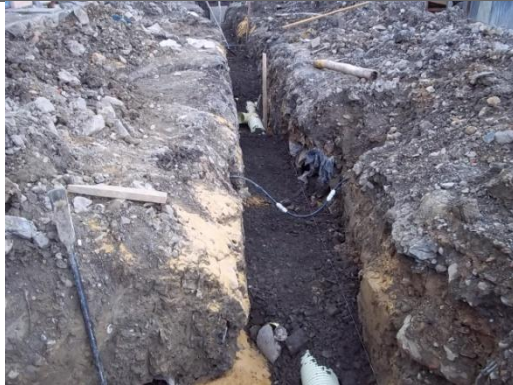
MATERIAL SELECCIONADO PARA PROTECCION DE TUBERIA
