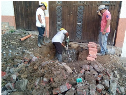
CAJAS DE INSPECCION
