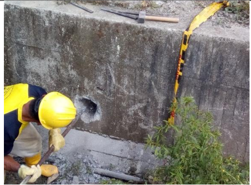
CAJA DE AGUAS LLUVIAS
