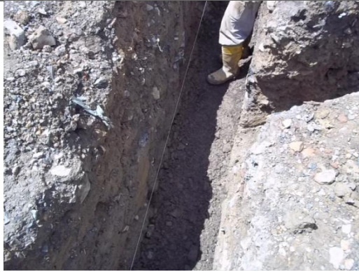
MATERIAL SELECCIONADO PARA PROTECCION DE TUBERIA
