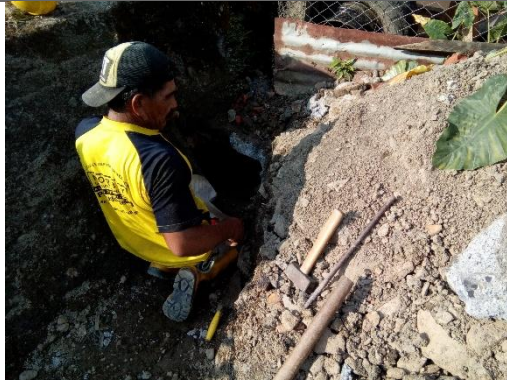
CAJA DE AGUAS LLUVIAS
