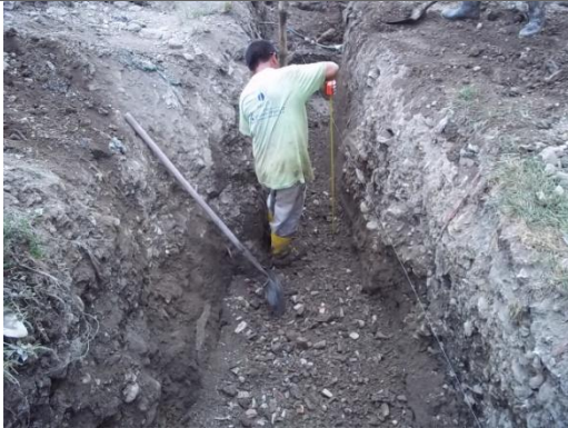
MATERIAL SELECCIONADO PARA PROTECCION DE TUBERIA
