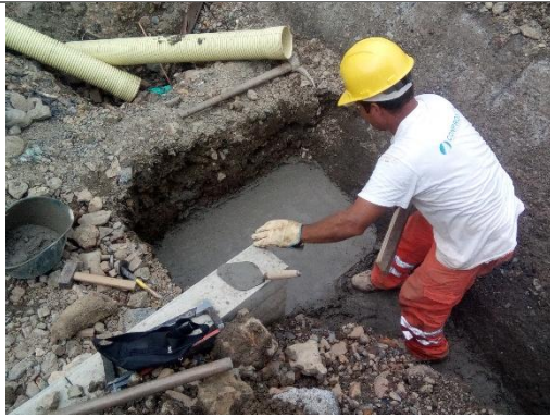
CAJA DE AGUAS LLUVIAS
