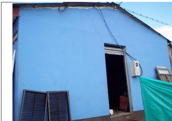
A PRIORI – CASA AFECTADA ANTES DE
