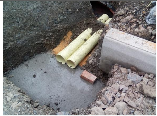
CAJA DE AGUAS LLUVIAS
