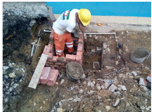
CAJAS DE INSPECCION
