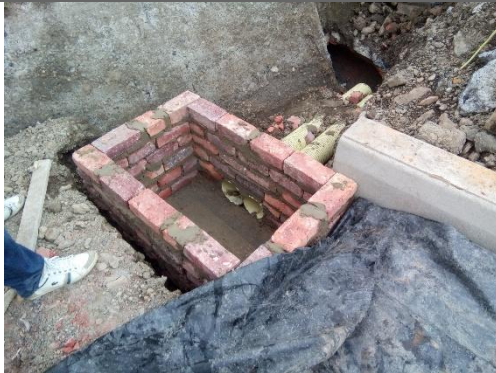
CAJA DE AGUAS LLUVIAS
