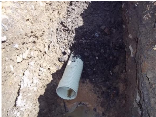
MATERIAL SELECCIONADO PARA PROTECCION DE TUBERIA
