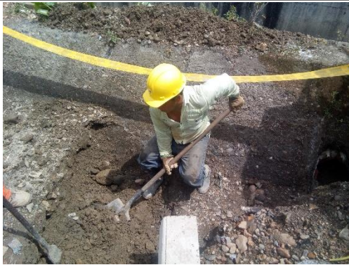
CAJA DE AGUAS LLUVIAS
