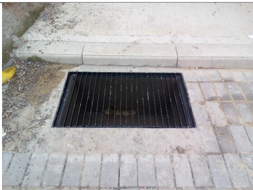
CAJA DE AGUAS LLUVIAS
