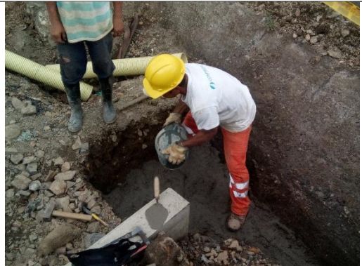
CAJA DE AGUAS LLUVIAS
