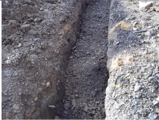
MATERIAL SELECCIONADO PARA PROTECCION DE TUBERIA
