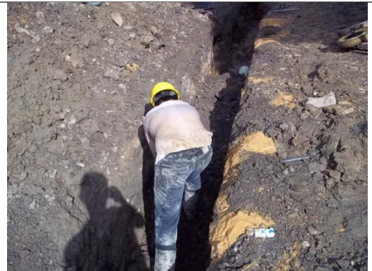
MATERIAL SELECCIONADO PARA PROTECCION DE TUBERIA
