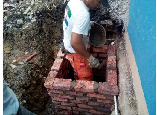
CAJAS DE INSPECCION
