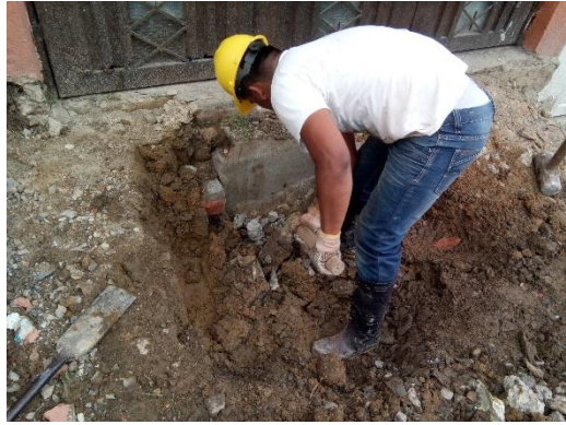
CAJAS DE INSPECCION
