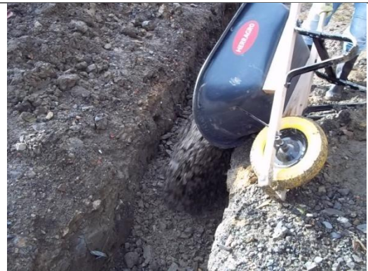
MATERIAL SELECCIONADO PARA PROTECCION DE TUBERIA
