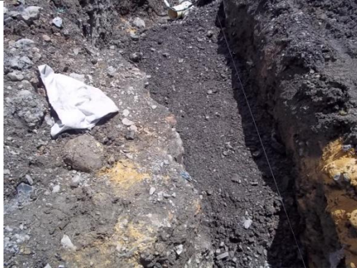
MATERIAL SELECCIONADO PARA PROTECCION DE TUBERIA
