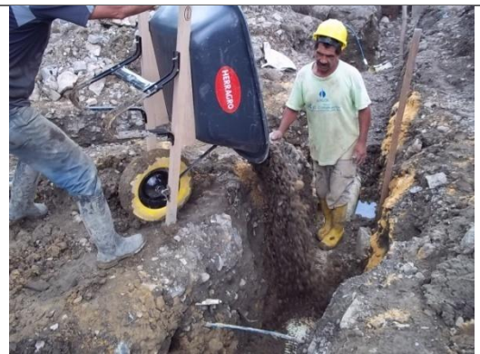
MATERIAL SELECCIONADO PARA PROTECCION DE TUBERIA
