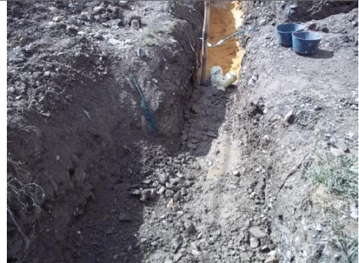
MATERIAL SELECCIONADO PARA PROTECCION DE TUBERIA
