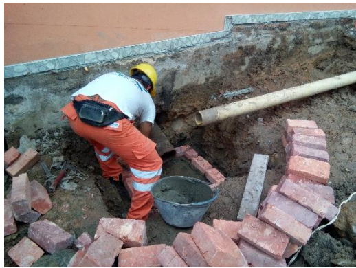
CAJAS DE INSPECCION
