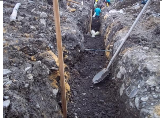
MATERIAL SELECCIONADO PARA PROTECCION DE TUBERIA
