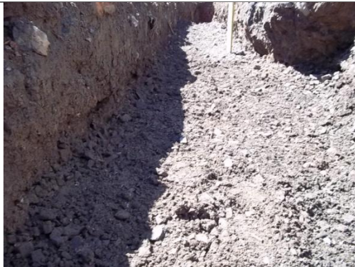
MATERIAL SELECCIONADO PARA PROTECCION DE TUBERIA
