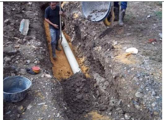
MATERIAL SELECCIONADO PARA PROTECCION DE TUBERIA
