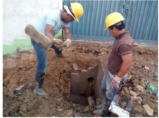
CAJAS DE INSPECCION
