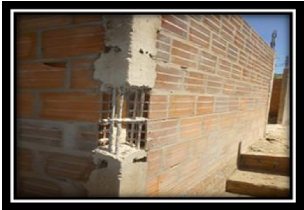
Imagen 15. Visita de obra, columneta en mal estado
