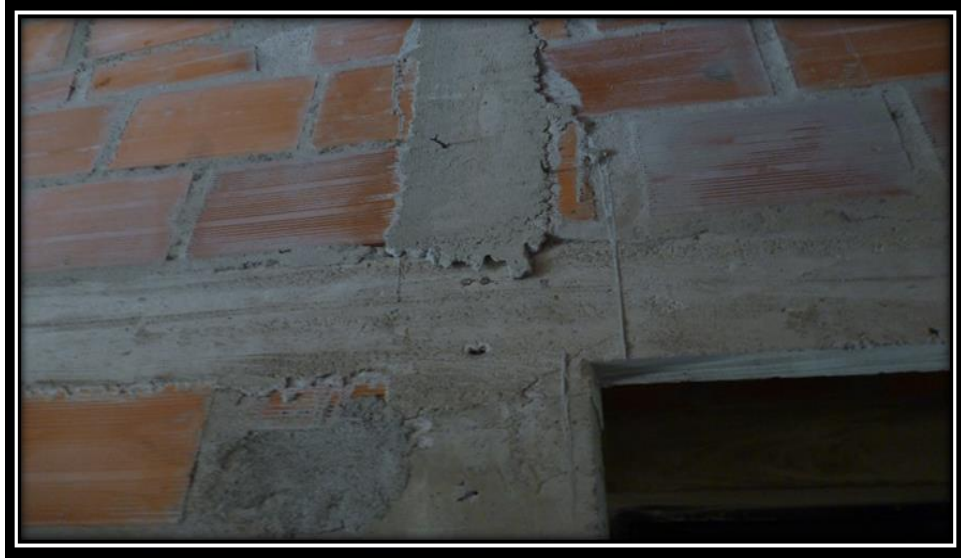
Imagen 33. Detalles por corregir en vigas en las casas de la 57-80
