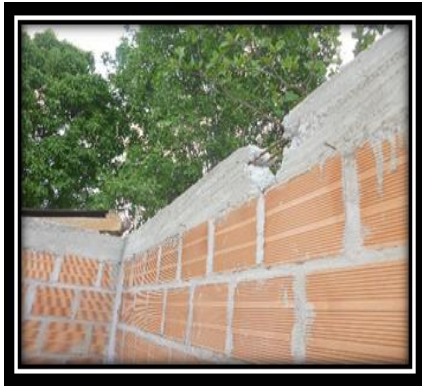
Imagen 16. Visita de obra viga en mal estado.
