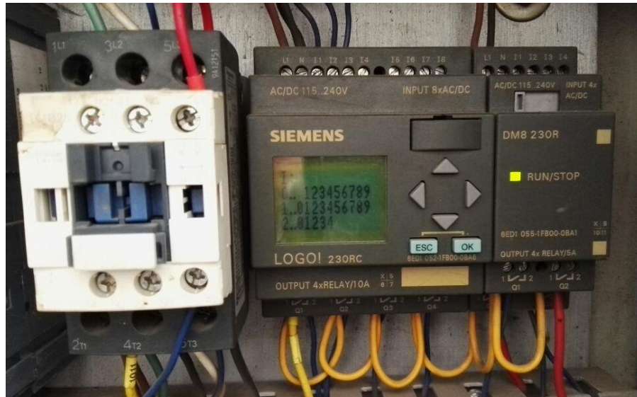
Figura 21. PLC con módulo de expansión y contactor.
