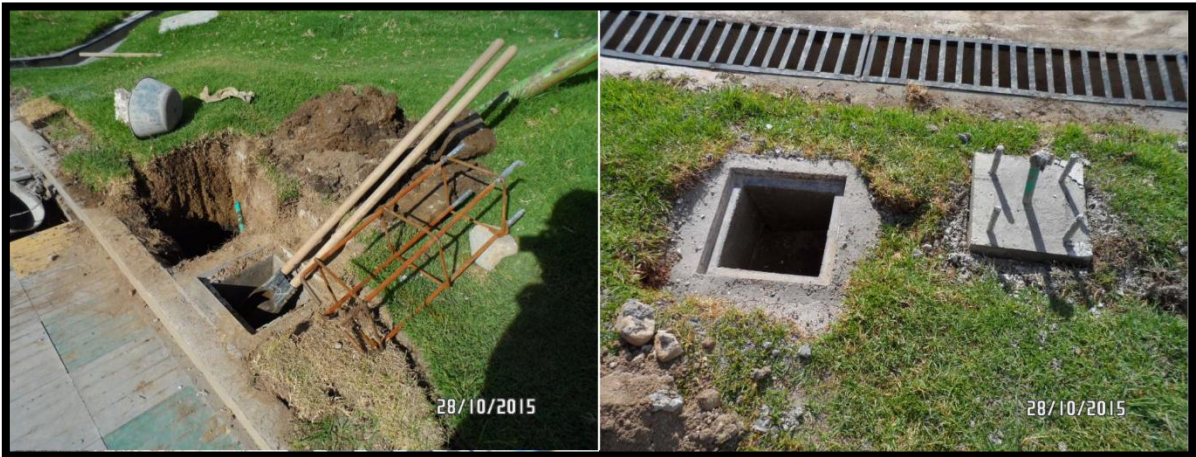
Imagen 64. Caja de Inspección de B.T
