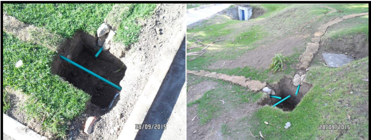
Imagen 643 Cajas de inspección de MT y BT
