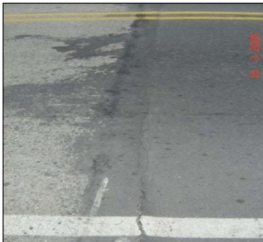
Figura 6. Fisura transversal en junta de construcción (FCT, Unidad de medida: m)
