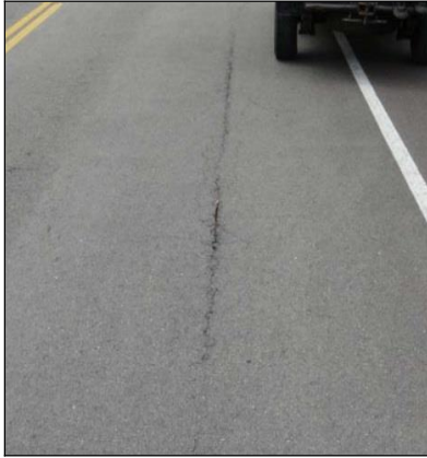
Figura 5. Fisura longitudinal en junta de construcción (FCL, Unidad de medida: m)
