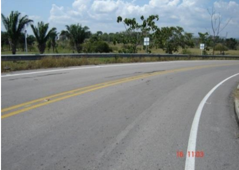
Figura 21. Desgaste superficial (DSU, Unidad de medida: m2)
