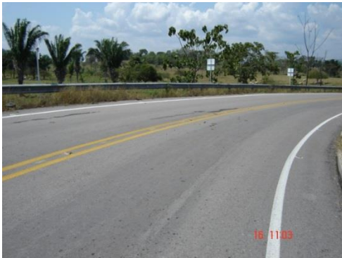
Figura 22. Pérdida de agregado (PA, Unidad de medida: m 2 )
