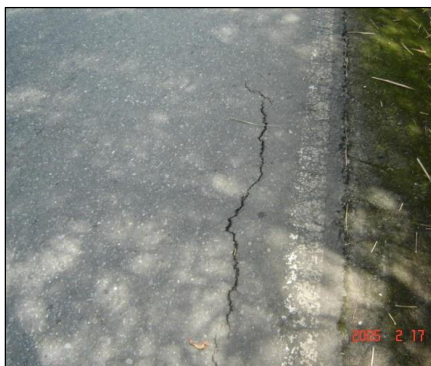
Figura 9. Fisuras de borde (FBD, Unidad de medida: m)
