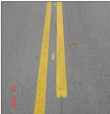
Figura 13. Fisuración incipiente (FIN, Unidad de medida: m 2 )
