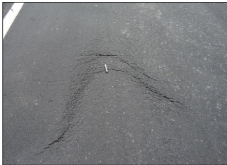
Figura 12. Fisuración por deslizamiento de capas (FDC, Unidad de medida: m 2 )
