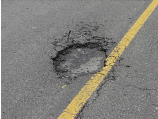
Figura 18. Descascaramiento (DC, Unidad de medida: m2)
