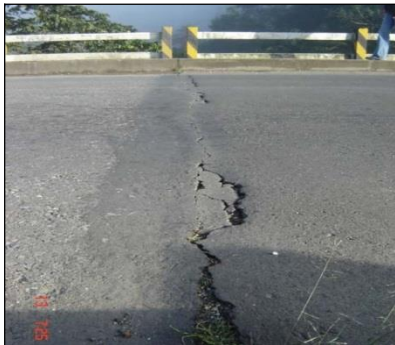
Figura 7. Fisuras por reflexión de juntas en placas de concreto (FJL o FJT, Unidad de medida: m)
