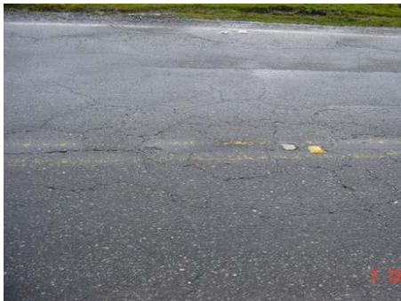
Figura 10. Fisuras en bloque (FB, Unidad de medida: m 2 )
