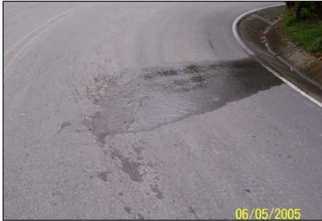
Figura 30. Afloramiento de agua (AFA, Unidad de medida: m)
