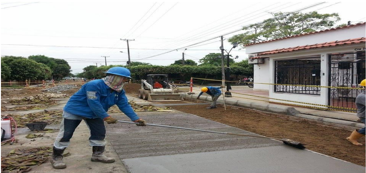
Imagen 32: rayado del concreto
