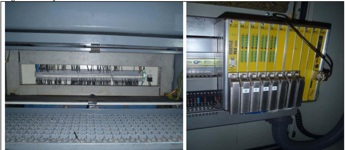
Figura 17. PLC y módulos transistores.
