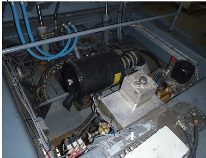
Figura 13. Sistema de potencia.
