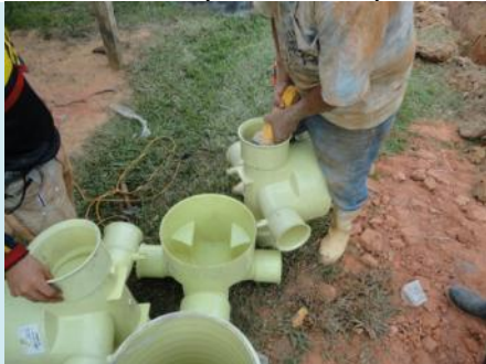
Cajas de inspección
