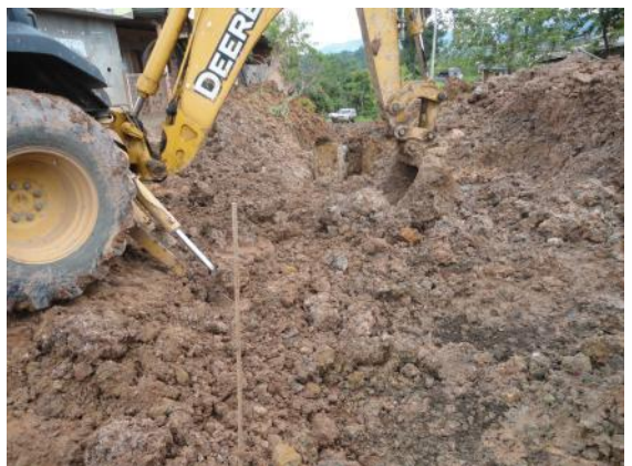
Suelos inutilizables para rellenar y compactar
