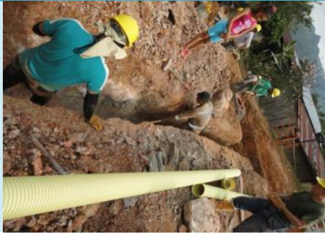
Tubería de 6" (domiciliaria)
