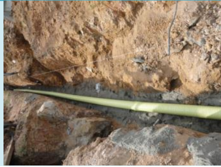
Tubería de 8" (red principal)
