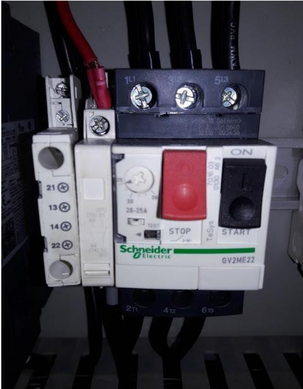
BREAKER GV2ME22, COMPONENTE ELECTRICO DE LA EXTRUSORA DE PLASTICO.
