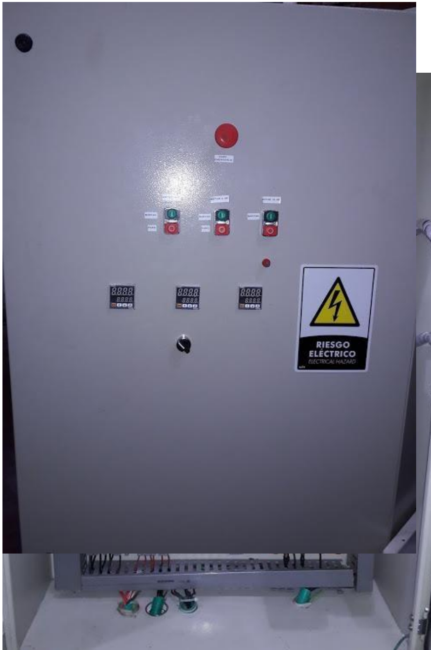
70. Tablero eléctrico para encendido de todas las maquinas. Ilustración 71. Parte frontal del tablero eléctrico.
