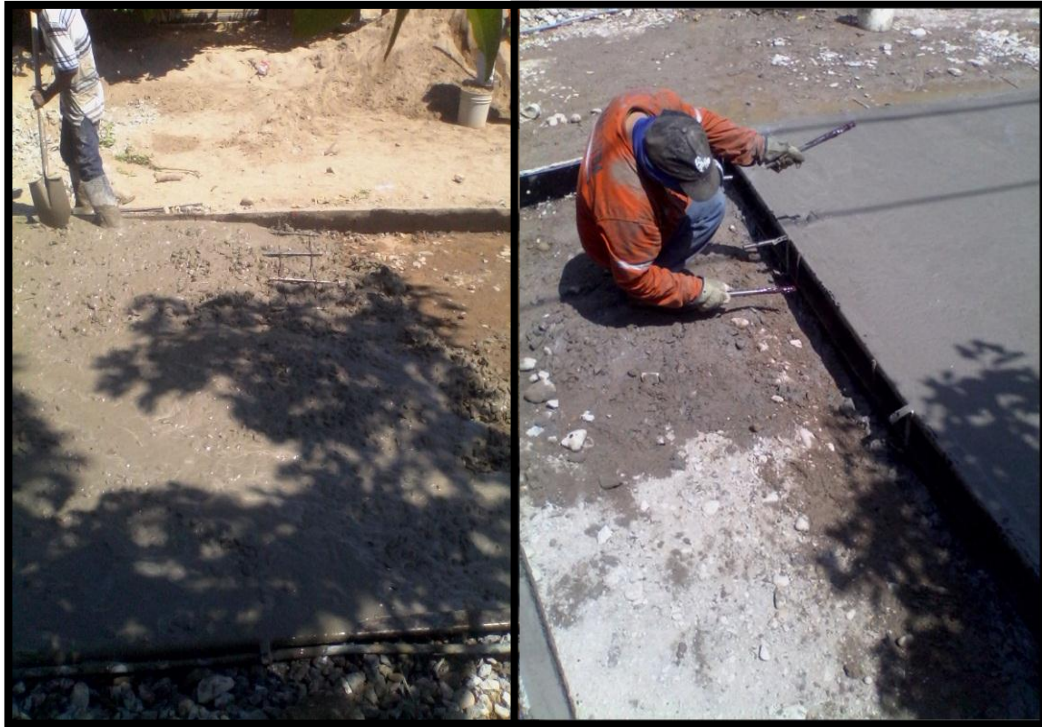
Ilustración 21 Colocación de pasadores por parrillas y pasadores por cierres de obras. Fuente: Autor
