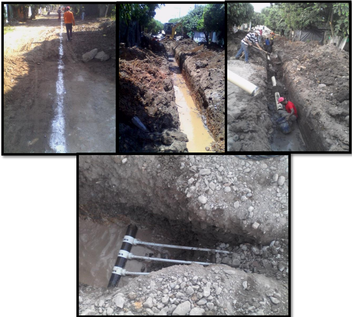
Ilustración 15 Tuberías de alcantarillado y agua potable Fuente: Autor
