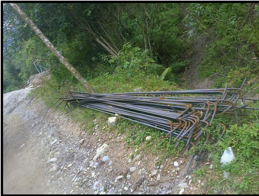
Ilustración 19 Aceros de Refuerzo
