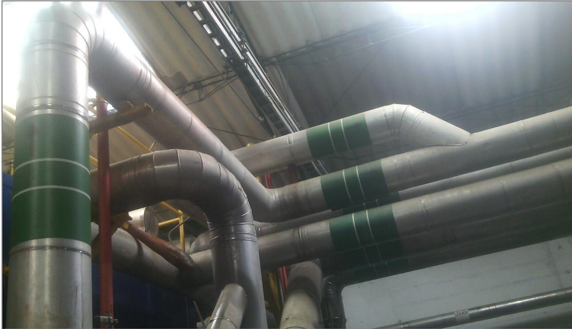
Figura 5.5 Tuberías de agua con aislamiento de lana mineral.
