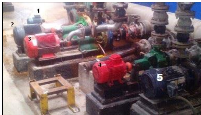
Figura 4.37 Bombas para el suministro del agua "fría"
