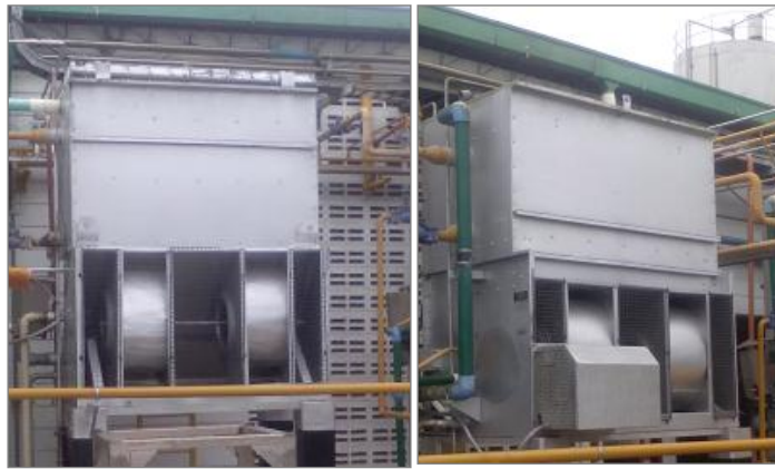
Figura 4.32 Condensadores evaporativos Evapco
