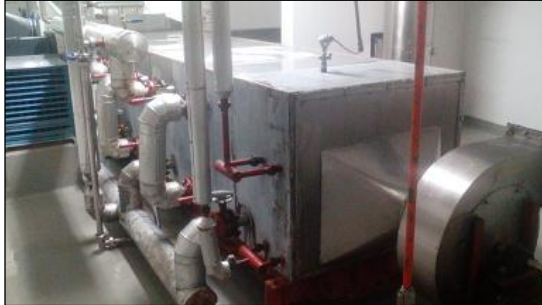
Ilustración 11 Deshumidificador de aire A. FACCINI & CIA AH 2011
