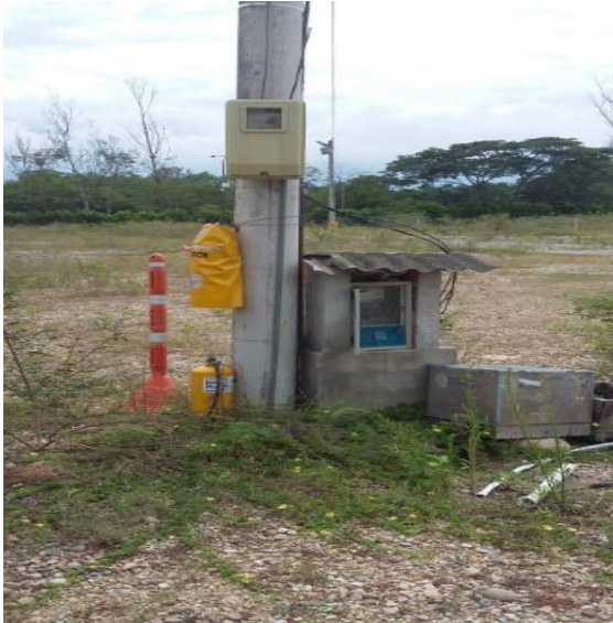
Imagen 7. Instalación Eléctrica. Fuente: Autor
