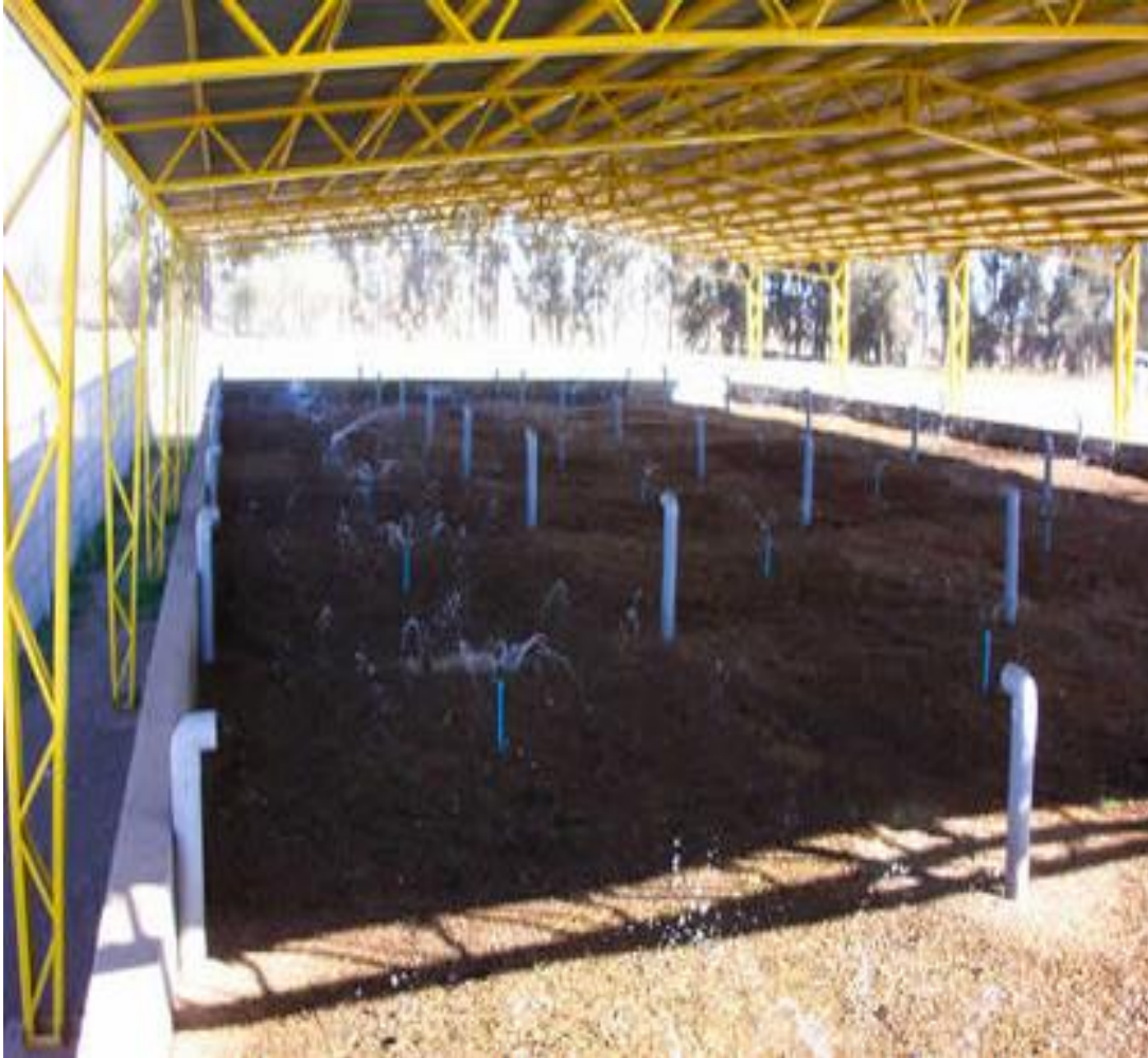
Figura 122. Lombrifiltro por aspersión planta para 2000 personas
