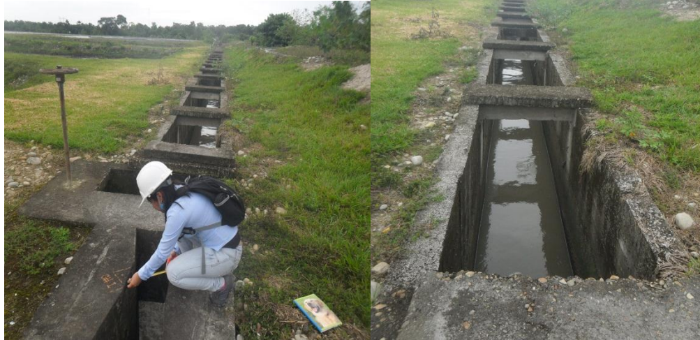
Fotografía 7. Canales de aducción para el primer tren.
