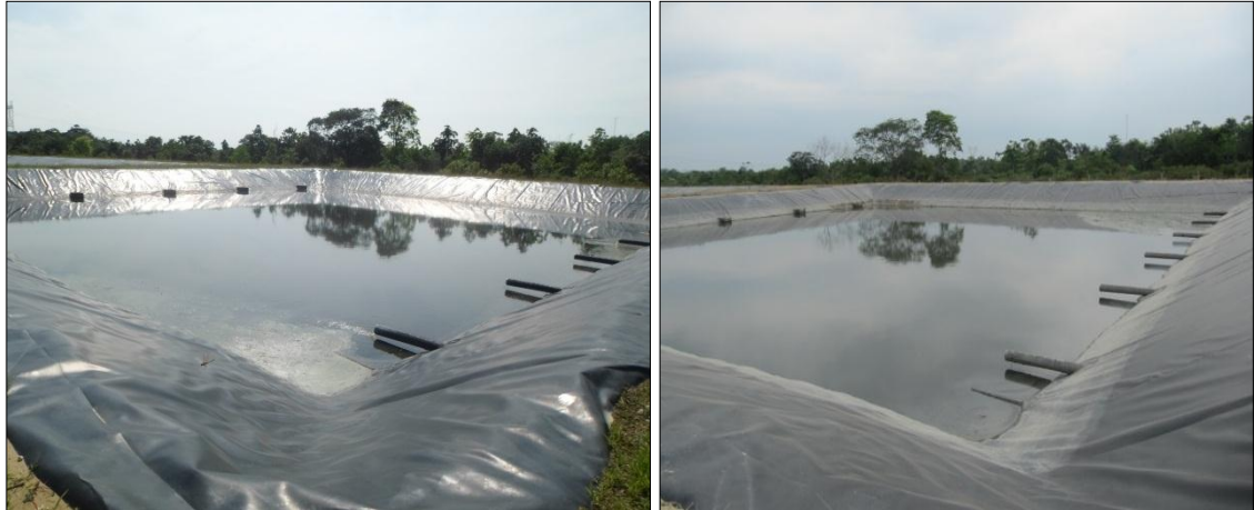
Fotografía 12. Lagunas anaerobias tren nuevo 1 y 2.
