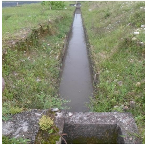
Fotografía 8. Canal de distribución segundo tren.
