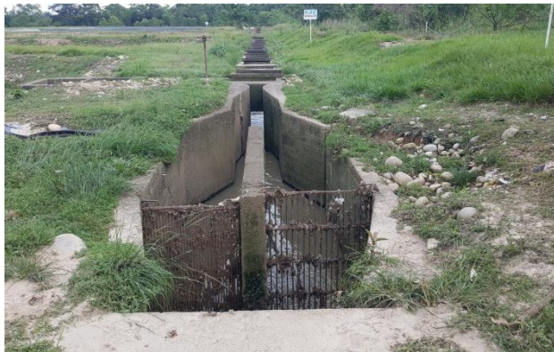
Fotografía 5. Rejillas antes de la Parshall.
