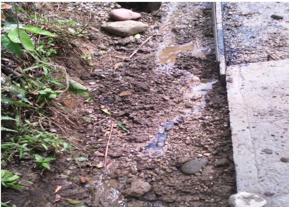
Imagen 8. Fotografía contaminación del suelo y agua por el uso de aceite quemado en la obra.
